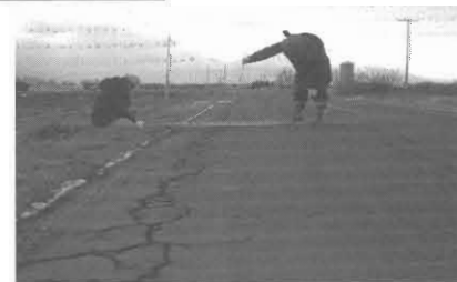
損傷している農道
