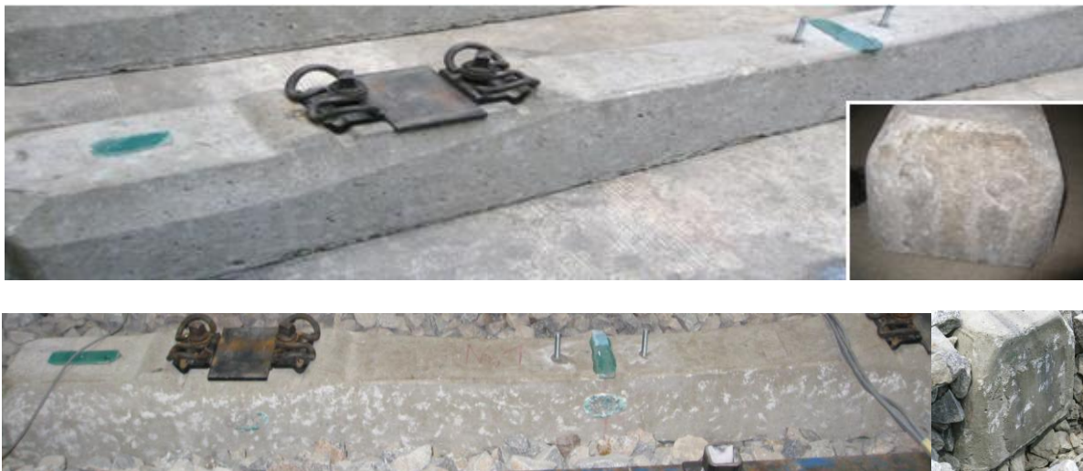
Abb. 3.3: Schwellenflanken nach dem Dauerschwingversuch (oben – konventionelle Schwelle; unten – Schwelle mit Sohle G04 V05).
