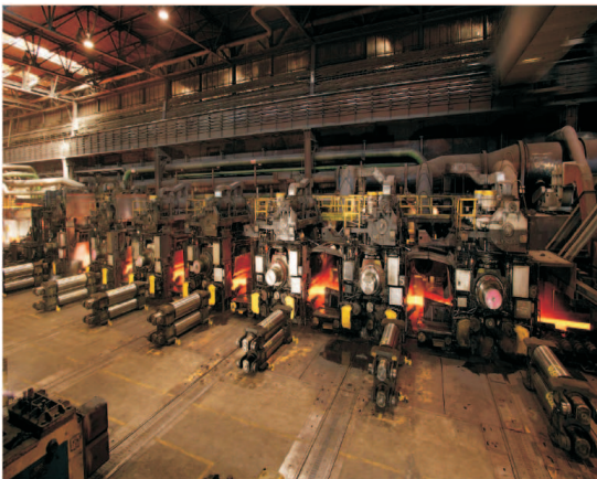
Abbildung 1.5: Fertigungsstraße der Warmbreitbandstraße voestalpine Stahl GmbH, Linz
