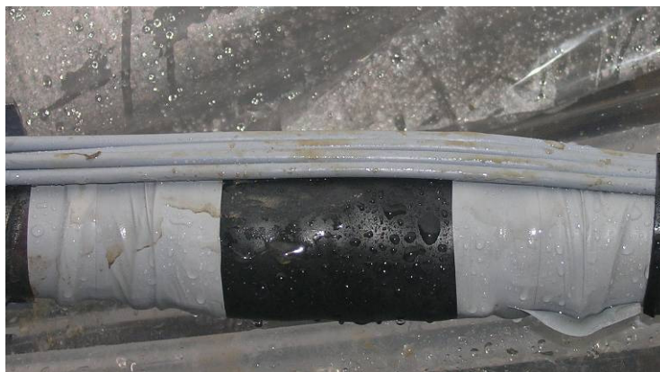
Abbildung 4.59: Mit Schrumpfschlauch und Klebeband geschützte Messstelle
