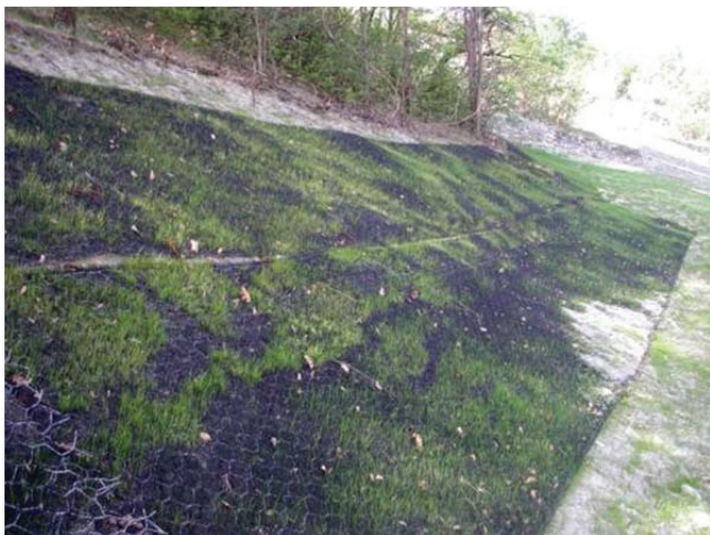
Abb. 8: Oberer Bereich des Konoids, Komposit einer geokunststoffbasierte Wirrgelegematte mit einem Stahlgeflechtnetz als Armierung mit anschließender Anspritzbegrünung
