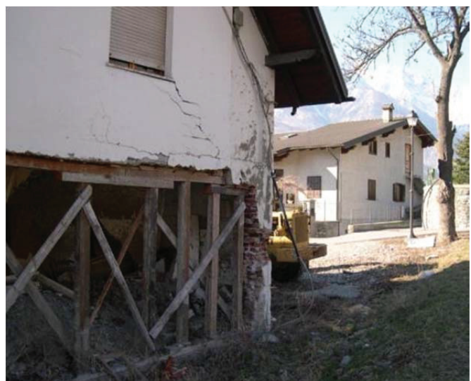
Abb. 4 : Okt. 2000 – Nus, beschädigtes Wohngebäude
