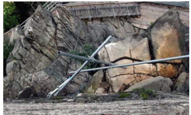
Abb. 5: Felsbereich unter dem Nordturm; deutlich zu erkennen sind die zahlreichen, hangparallelen und bis zu 10 cm weit geöffneten Trennflächen, die das Gestein/Gebirge zerlegen. (Foto 13.04.2010)
