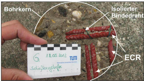
Bild 10: Freigelegte epoxidharzbeschichtete Bewehrung an der Bruchfläche (Unterseite) eines entnommenen Bohrkerns
