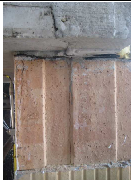
Rissbildung am Wandkopf (nur im Wan- deckbereich)
