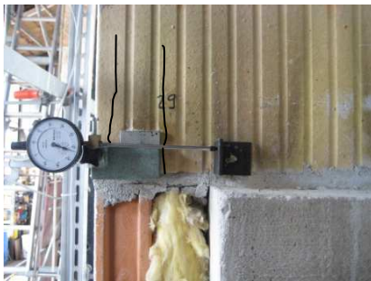
fortschreitende Rissbildung am Wandfuß
