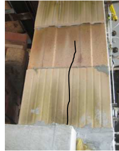
Rissbildung am Wandfuß im Bereich der Querstege
