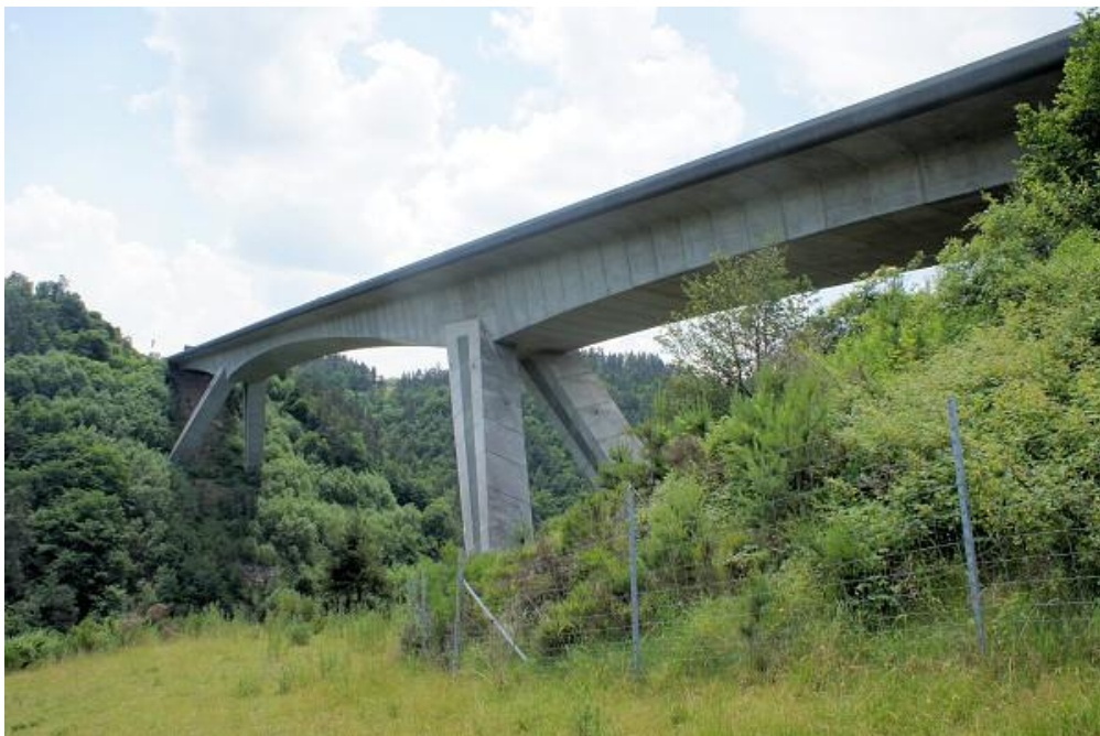
Abbildung 7.1.1: Das Referenzbauwerk für den Anwendungstest. Es handelt sich um die Autobahnbrücke „Pont sur la Truyere“ in Frankreich. Das mit Spannbeton gebaute Hohlkasten-Brückenbauwerk ist 310 Meter lang und 20, 5 Meter breit. Die Spannweiten zwischen den zwei Pfeilern betragen 83 Meter, 144 Meter und 83 Meter (Structurae, 2013).
