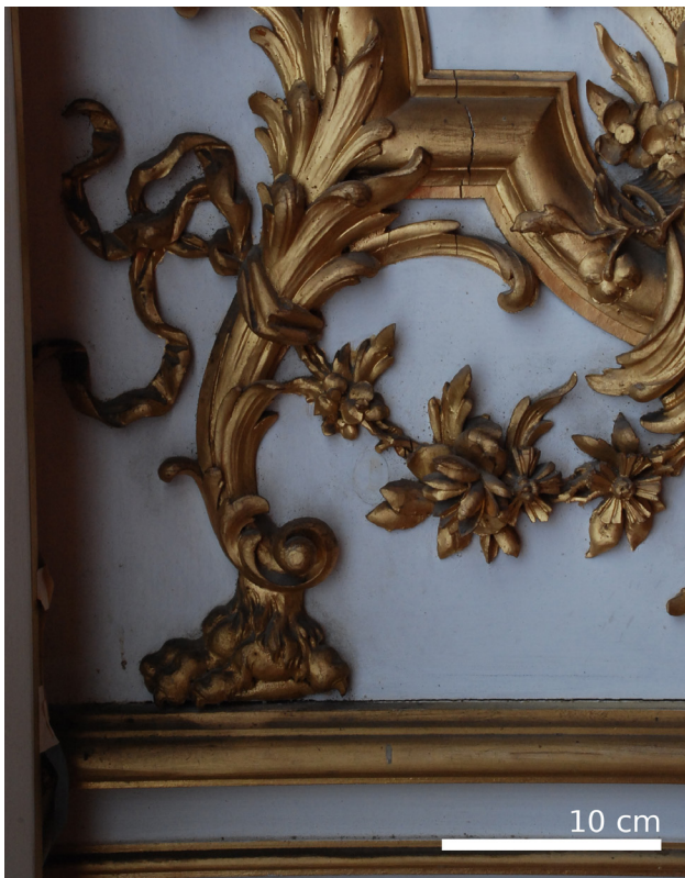
Abbildung 4.11: Vergoldete Holzornamente der wandfesten Ausstattung im Paradeschlafzimmer haben geringe Lockerungen und Substanzverluste.
