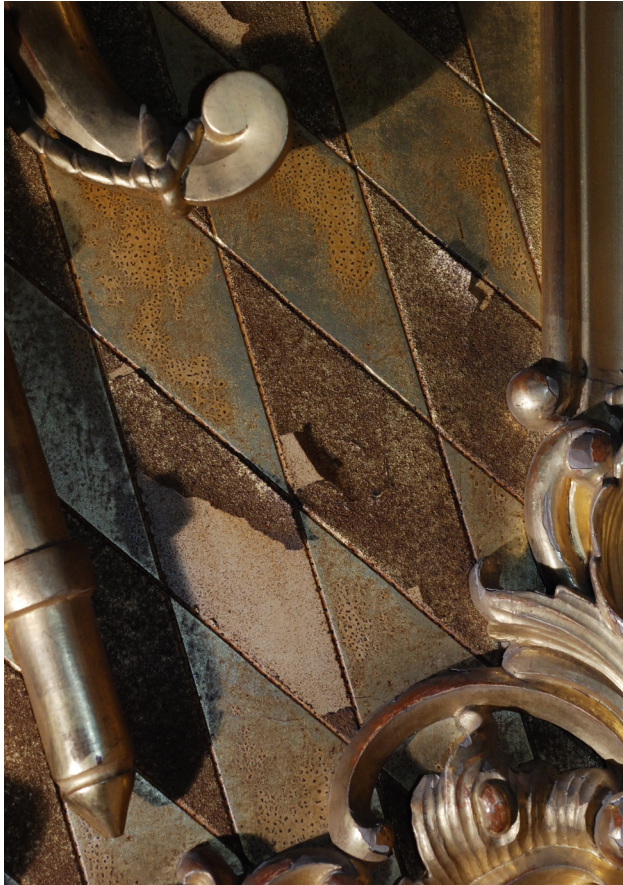
Abbildung 4.9: Insbesondere gesandelte Vergoldungen weisen starke Lockerungen und Substanzverluste auf. In den Glanzvergoldungen sind lokale Oberflächenveränderungen ähnlich Frühschwundrissen sichtbar (Westliches Gobelinzimmer).
