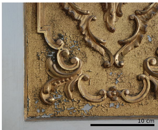
Abbildung 4.16: Vergleich des Zustands 1992 (oben) und 2012 (unten) an vergoldeten Rücklagen der nördlichen Balkontür (Audienzzimmer, Westwand). Verstärkte Abplatzungen und Lockerungen der Sandelung durch ein Mikroklima, das sich bildet, wenn die Sonne über die Fläche wandert.
