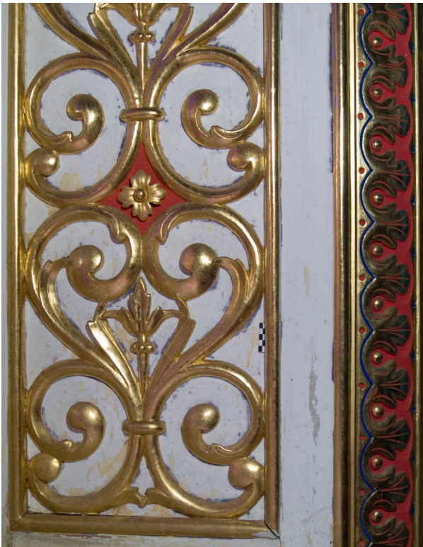
Abbildung 4.28: Türkischer Saal, nordwestlicher Fensterstock: Verschwärzung der Weißfassung.
