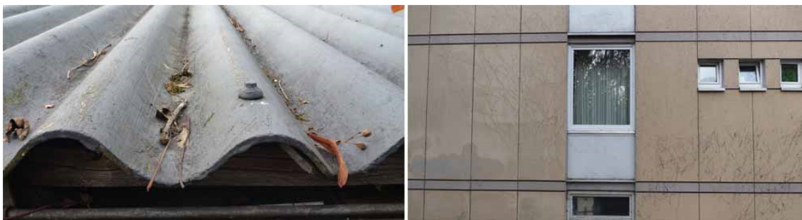
Abbildung 90: Beispiel für asbesthaltige Bauteile (Eigene Bilder)
