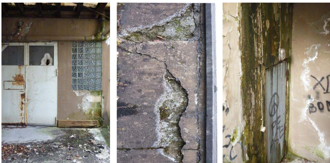
Abbildung 86: Bauschäden an 10 Jahre brachliegendem Gebäude (Baujahr 1964) (Eigene Bilder)
