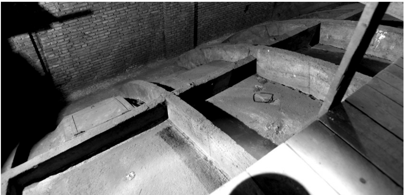
Abb. 283: Das Deckengewölbe der Margaretenkirche (hier Chorgewölbe) mit oberseitig angeordneten Rippen (Foto: JR).
