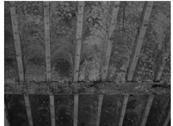
Abb. 287: Koenen'sche Plandecke, an Doppel-T-Träger anschließend, im Gisela-Gymnasium (ehemaligen Kreisrealschule) in einer Aufnahme von 2007 (Foto: JR).
