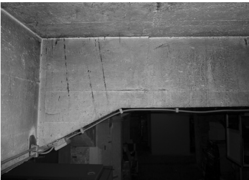
Abb. 303: Kellergeschoss Lindwurmhof: Ablesbare Bügelbewehrung (Foto: JR).
