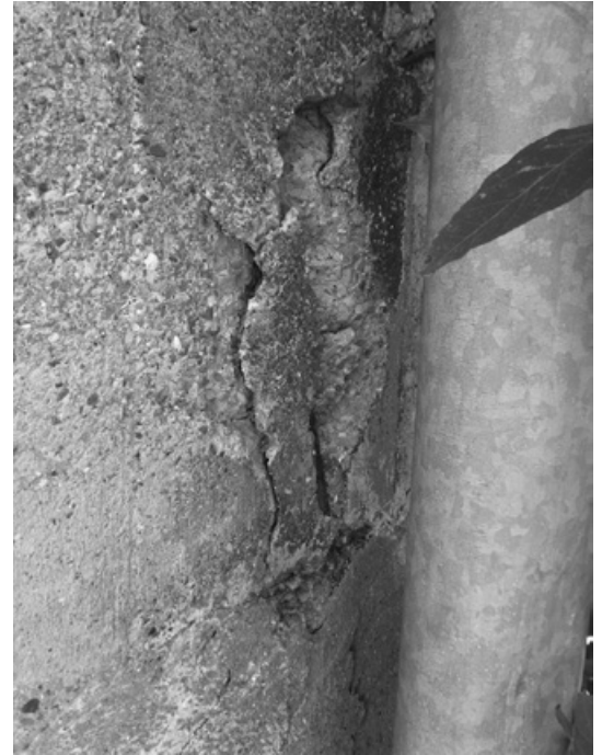
Abb. 337: Ablösung von Betonüberdeckungen hinter einem Regenfallrohr am Körnermagazin in Ingolstadt (Foto: JR).
