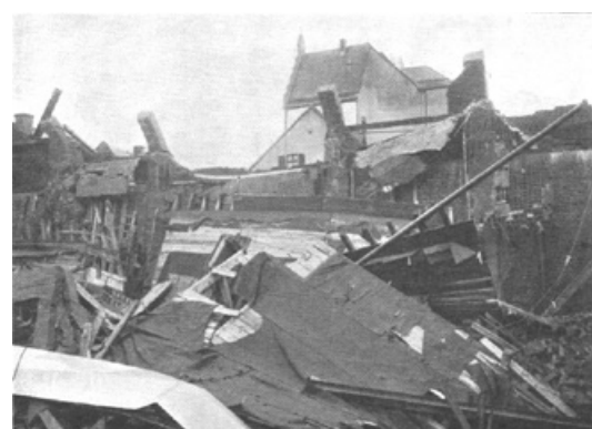
Abb. 136: Einsturz einer Eisenbetonkonstruktion während der Bauphase (Kollmann 1912, S. 42).
