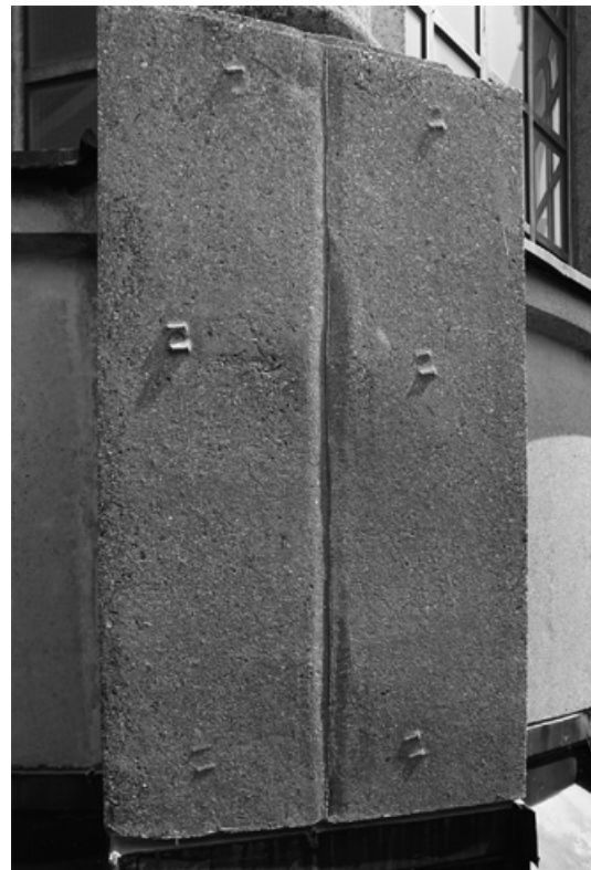
Abb. 427: Einer der acht Pfeiler der Laterne. Hier gut zu sehen sind die nachträglich eingesetzten Verbindungsanker und der etwas wellige Aufbeton, wohl verursacht durch eine Blechschalung (Foto: JR).
