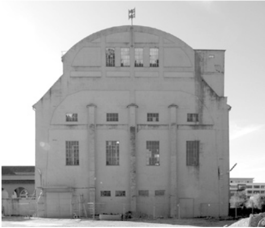
Abb. 699: Das Ofenhaus von der Rückseite. Die geplante Verlängerung wurde nie ausgeführt. Deutlich ablesbar sind die Binderkonstruktionen (Foto: JR).
