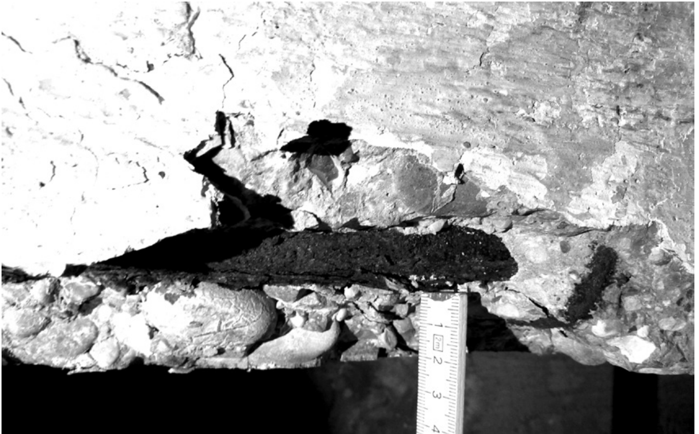
Abb. 333: Spaltkorrosion an einem Biegebalken im Lindwurmhof im Kellergeschoss (Foto: JR).
