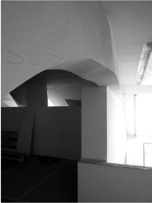
Abb. 339: Verformter Binder in einem Atelier des Thierschbaus der TUM (Foto: JR).
