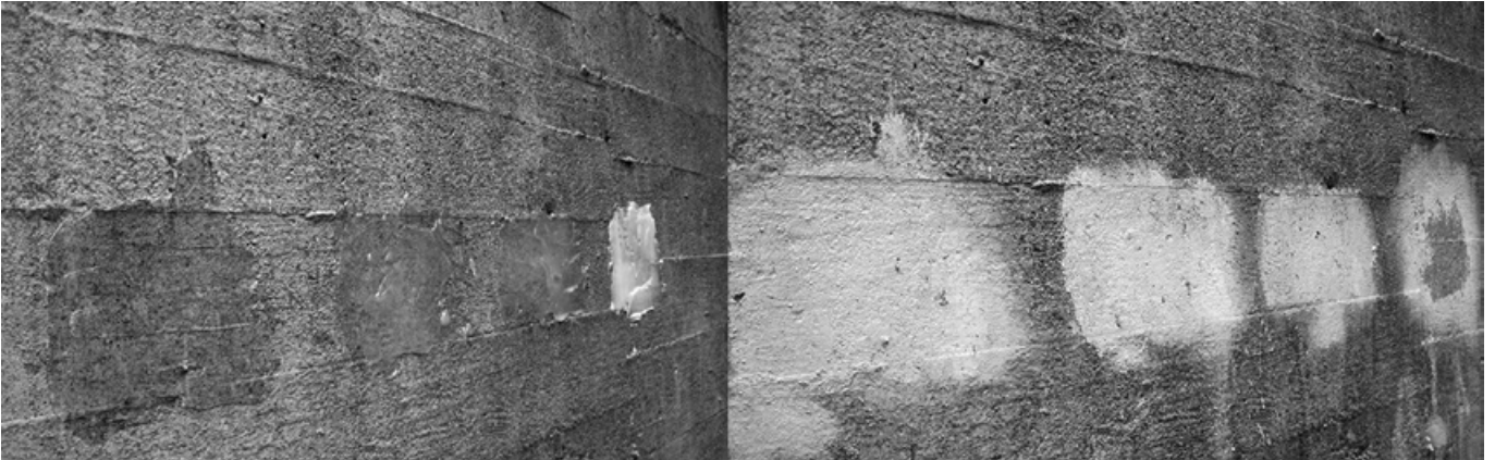
Abb. 346: Testflächen an einer nachträglich durch Unterhaltsmaßnahme beschichteten Sichtbetonoberfläche (Foto: JR).
