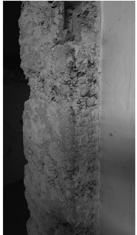
Abb. 334: Kiesnester an einem Wandbauteil im Thierschbau der TUM (Foto: JR).
