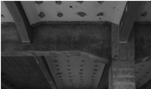
Abb. 80: Deutsches Museum, ehemalige Chemiesammlung. Deutlich zu sehen sind die Vouten, die von den Unterzügen zu den Stützen vermitteln. Außerdem auch hier zu sehen: Vouten zwischen Platte und Unterzug (Foto: JR).
