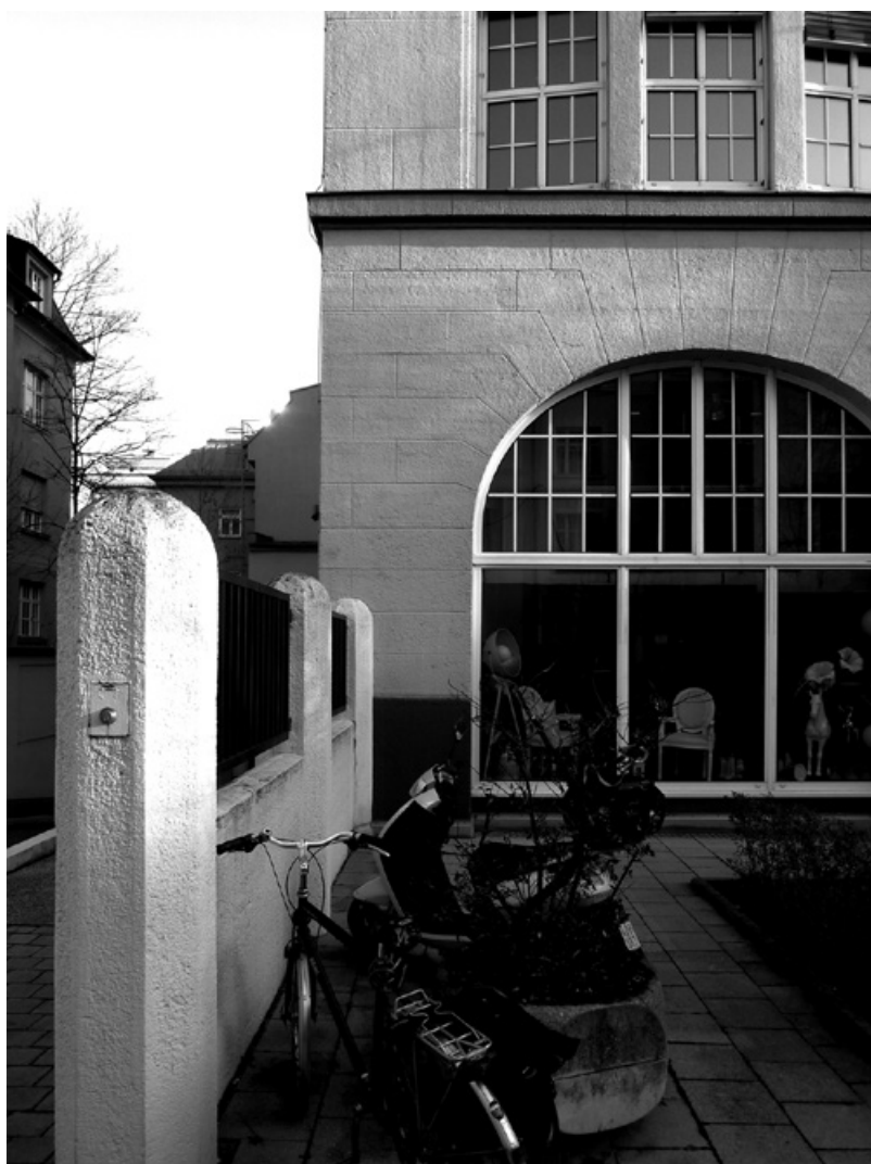
Abb. 739: Sichtbeton an den Fassaden: Durch steinmetzmäßige Bearbeitung wurde der Fugenschnitt einer Natursteinfassade imitiert. Die Oberfläche wurde mindestens ein Mal farbig beschichtet (Foto: JR).
