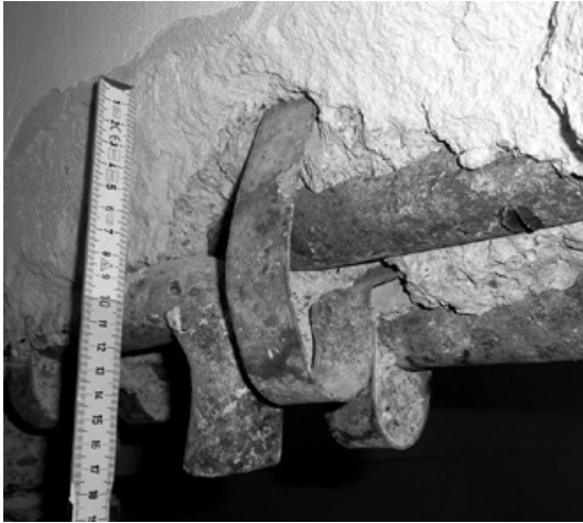
Abb. 34: Bewehrung nach System Hennebique im ehemaligen Arbeitermuseum in München von 1905 (Foto: JR).
