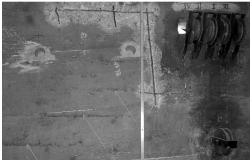
Abb. 324: Ehem. Arbeitermuseum: Abfallende Betondeckung und sich abzeichnende Bewehrung im Dachraum (Foto: JR).
