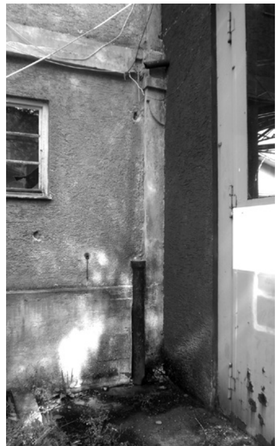
Abb. 344: Fehlendes Regenfallrohr am ehemaligen Körnermagazin (Foto: JR).
