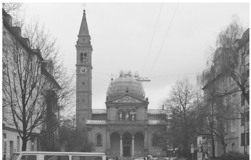
Abb. 371: Blick von Süden auf die Kirche während der Instandsetzungsarbeiten an der Kuppel um 2017 (die Laterne wurde bereits abgenommen). (Foto: JR).
