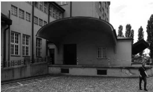
Abb. 8: Ein dünnwandiges Vordach an einer Laderampe des Hauptzollamts (Foto: JR).
