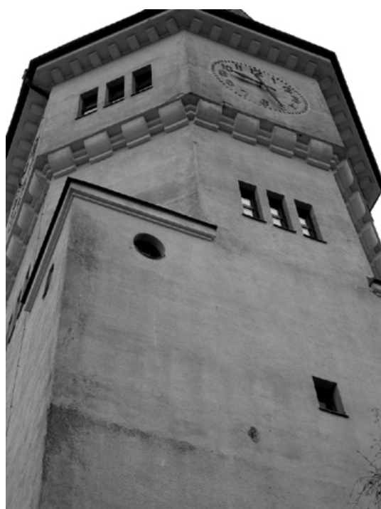
Abb. 477: Auf der Westseite bestehen einzelne Schäden, die auf Bewehrungskorrosion zurückzuführen sind (Foto: JR).
