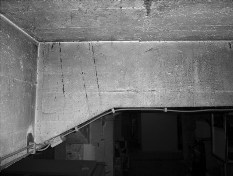
Abb. 644: Unterzug im Kellergeschoss mit sich abzeichnenden Bügelbewehrungen (Foto: JR).
