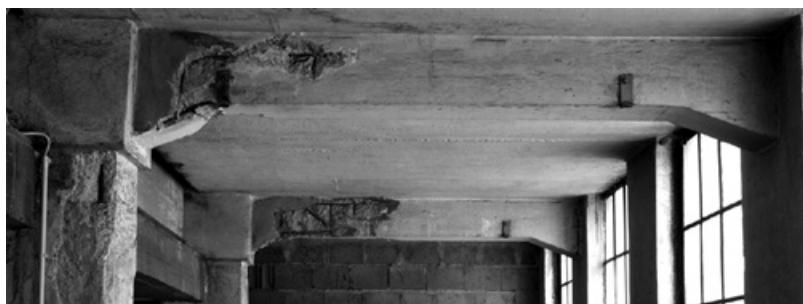
Abb. 708: Unterzugdecke mit korrosionsbedingten Schäden (Foto: JR).
