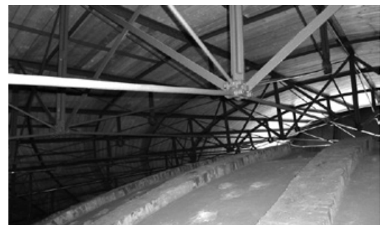
Abb. 229: Der obere Abschluss der Befreiungshalle. Die innere Kuppel wurde als gemauerte Rippenkuppel ausgeführt. Die äußere Kuppel als Bindertragwerk aus Eisen (Foto: JR).
