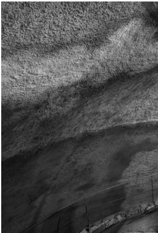
Abb. 424: Innenseite der äußeren Kuppelschale mit rezent appliziertem Zement- oder Spritzputz. Die ehem. erhabenen Meridiane sind nicht mehr sichtbar (Foto: JR).
