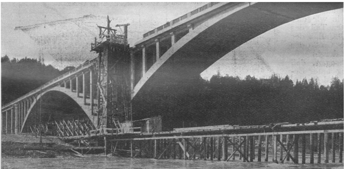
Abb. 773: Kurz vor Fertigstellung. Die zwischen Bogen und Fahrbahn eingestellten Stützen sind gut erkennbar (DBZ 1904, S. 49).
