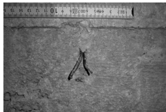
Abb. 196: Bindedrähte am Kernbeton im Deutschen Museum, die durch die ausgeführte Vorsatzschale aus Bimsbeton nicht gänzlich abgeschnitten wurden (Foto: JR).
