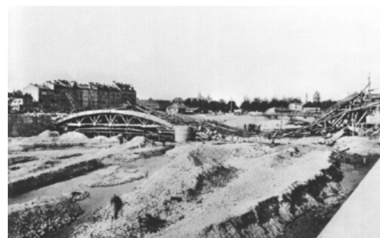
Abb. 135: Einsturz eines Gerüstbogens während der Betonierarbeiten an der Corneliusbrücke in München (Rädlinger 2008, S. 151).
