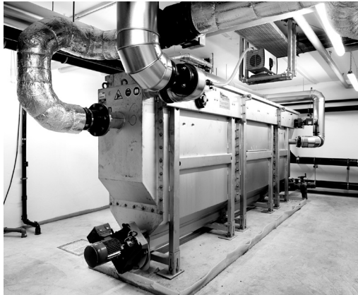
Abbildung 01-06: Abwasserwärmerückgewinnung der zentralen Sterilgutversorgung am Klinikum rechts der Isar [Arlt 2014]
