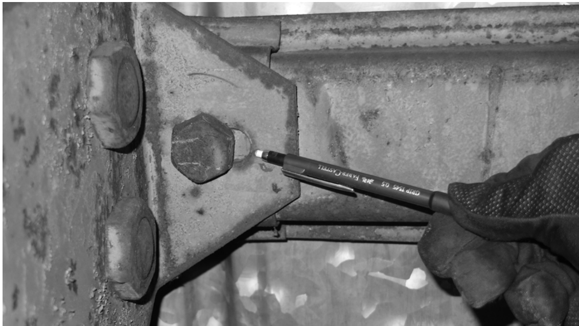
Abbildung 3.3: Junkershalle Oberschleißheim: Langloch an der Verbindung der Oberpfetten zum Backenblech des Knotenpunktes (Foto: JT, 2015).
