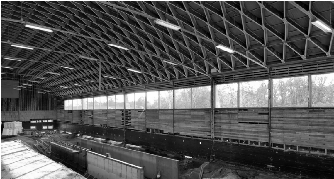
Abbildung 7.7: Sporthalle Ollerup/Dänemark: Generalsanierung der Halle bei geschlossenem Dachtragwerk. Aus: (Gymnastikhøjskolen i Ollerup: Fra Idrætshal til Arena 2019).
