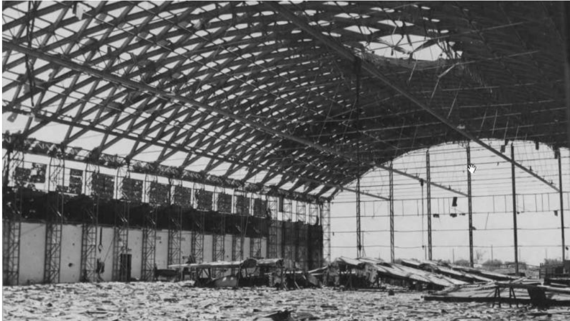
Abbildung 3.17: Hangar Comiso/Italien: Großflächiger Schaden im First des Daches. Die Schadensursache ist unbekannt, eine Kriegseinwirkung jedoch naheliegend (Foto: unbekannt, 1944).
