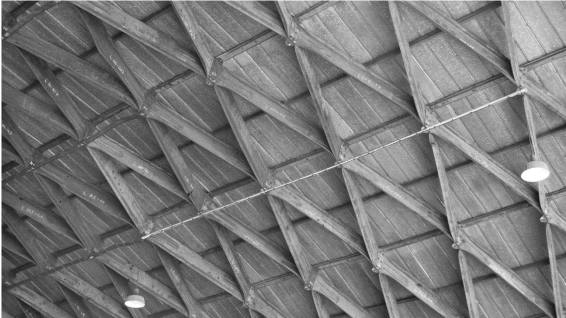
Abbildung 3.12: Hangar Oberschleißheim: Großflächig fehlende Unterpfetten und geknickte Unterpfetten im Anschluss an diesen Bereich (Foto: JT, 2018).
