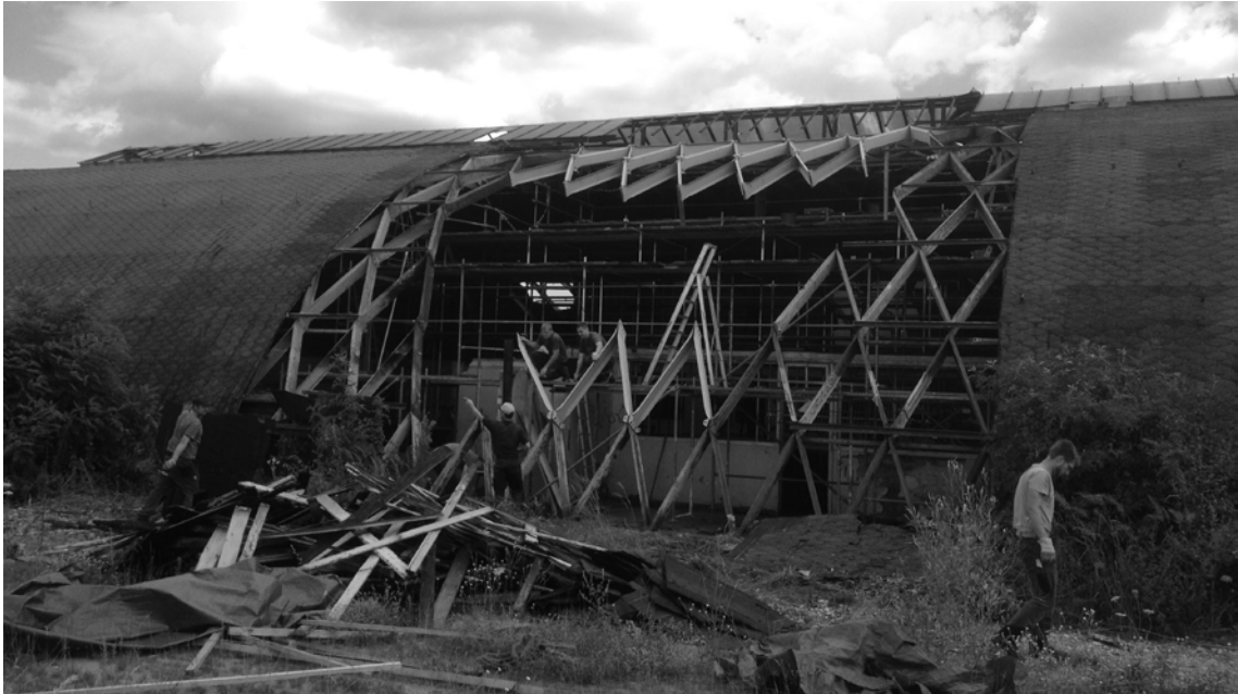
Abbildung 3.19: Junkalor-Halle Dessau: Sanierung des Brandschadens (Foto: Fa. Schulze, 2015).
