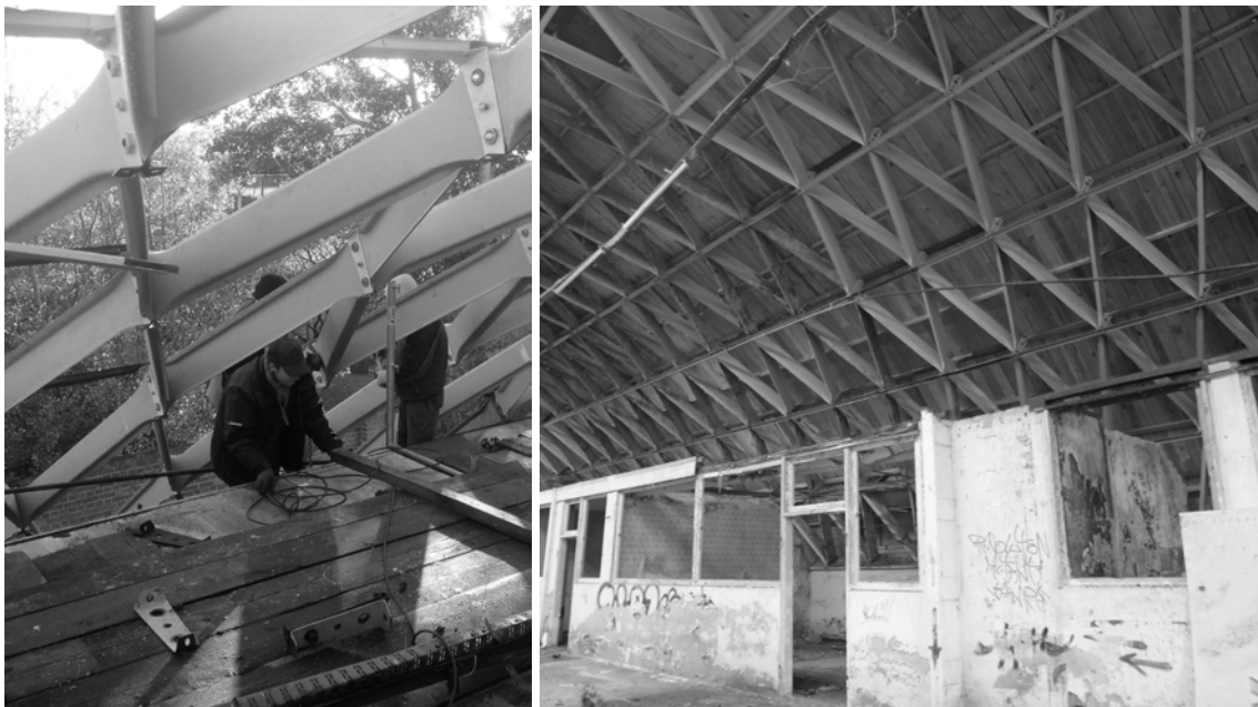
Abbildung 7.5: Junkalor-Halle Dessau: Sanierung eines Brandschadens (rechts, Foto: Fa. Schulze, 2015) und Innenansicht nach Wiedereindeckung (links, Foto: JT, 2018).
