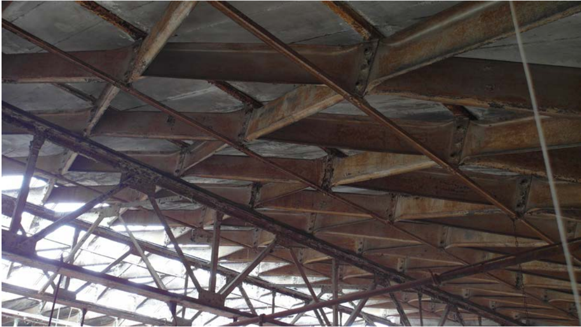
Abbildung 3.20: Junkers-Werkhalle Dessau: Leichte Korrosion der Bauteile (Foto: JT, 2016).
