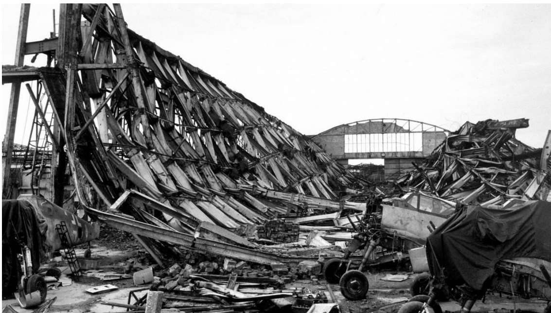
Abbildung 3.18: Hangar Leipzig: Gesamteinsturz des Daches. Die Schadensursache ist unbekannt, eine Kriegseinwirkung jedoch naheliegend (Foto: Margaret Bourke-White, 1945).
