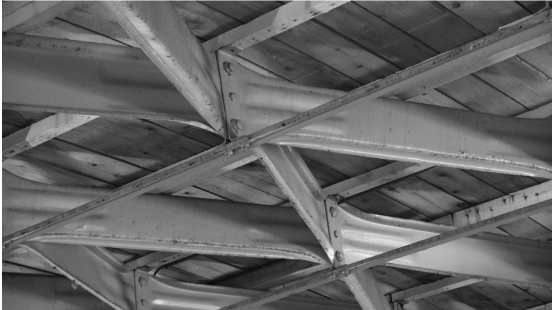
Abbildung 3.9: Wasserwerk Dessau, Pumpenhaus: Neue Ober- und Zwischenpfetten aus Holz und fehlender Anschluss an die Backenbleche des Knotenpunktes (Foto: JT, 2018).
