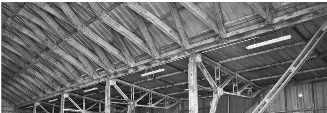
Abbildung 3.4: Junkershalle Oberschleißheim: Die Position der Fachwerkrahmen passt nicht zum Lamellenraster des Daches. Das erste Feld hat ein sichtbar kleineres Stahlprofil als Fußpfette als die anderen Felder (Foto: Benedikt Philipp, 2015).
