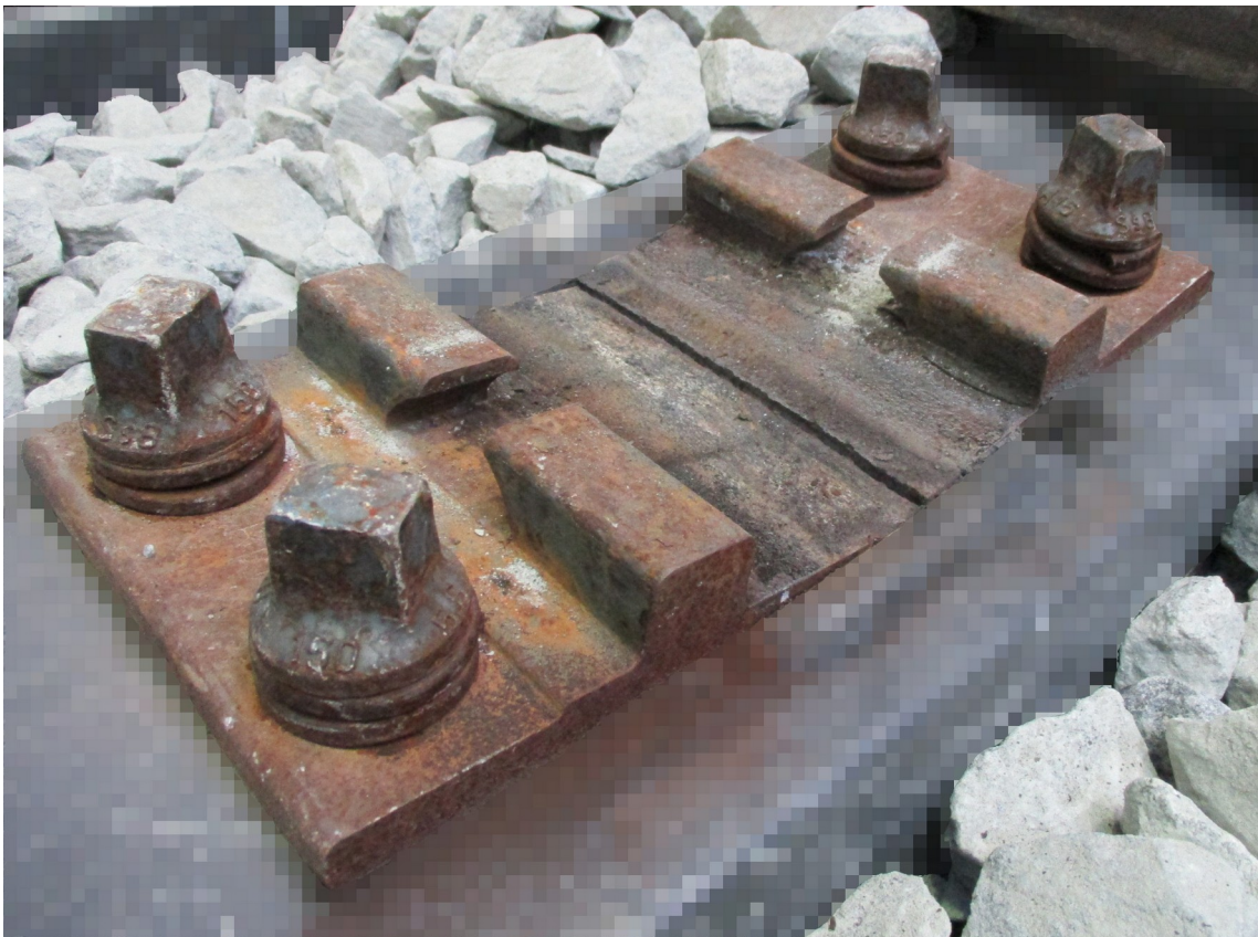
Abbildung 4.1: Gebrochene und in die Schwelle eingearbeitete Rippenplatte
