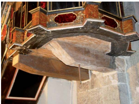
Abb. 7 Kanzel der Marienkirche in Bergen, Unterseite des Kanzelkorbes. Zu sehen sind die beiden Tragebalken, die im Mauerwerk verankert sind.
