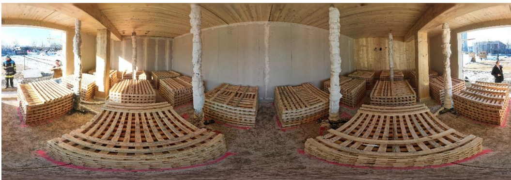
Bild 13 180° Drohnenaufnahme aus dem Inneren des Brandraumes (V4)
