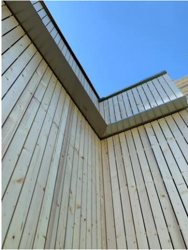
Abb. 10: Brandsperre aus Stahlblech
