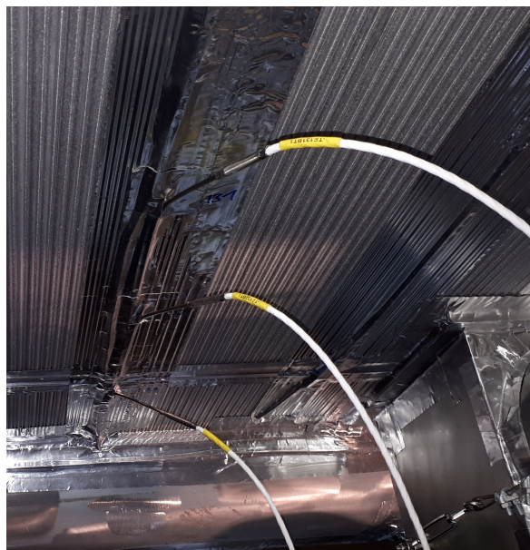
Abbildung 4.9: Anbringung der Oberflächen-Pt100
