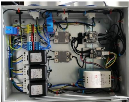
Abbildung 132 Versorgungsschaltschrank mit Elementen zur gezielten Ansteuerung einzelner Geräte über die Außensteckdosen sowie jeweils getrenntem Verbrauchsmonitoring
