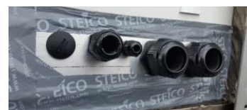
Abbildung 129 Durchführungsplatte im eingebauten Zustand (Außenansicht)
