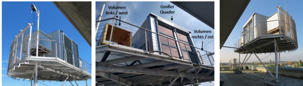
Abbildung 99 Solarstation auf dem Dach des TUM Hauptgebäudes - vor, während und nach dem Umbau
