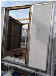
Abbildung 112 Teile der alten Eternitbeplankung
