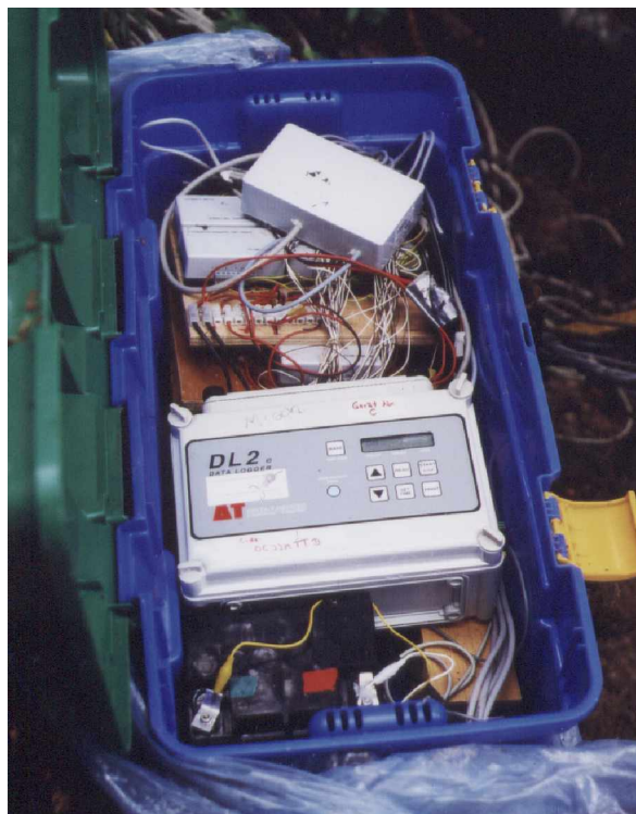
Abb. A7: Steuerelektronik des Buchen-Fichten-MischBestandes am Sperrgraben. Blick auf den Logger, die Konstantstromversorgungen und den Tiefentladungsschutz.
