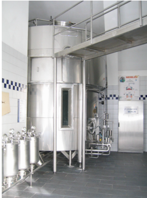
Abbildung 46: Erste industrielle Anlage
