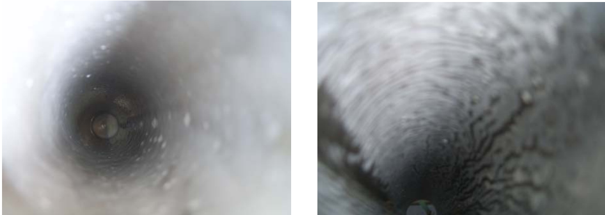
Abbildung 4.12: Aufnahme der komplett verschmutzten Rohr-Innenoberflächen vor (links) und nach (rechts) dem Trocknen
