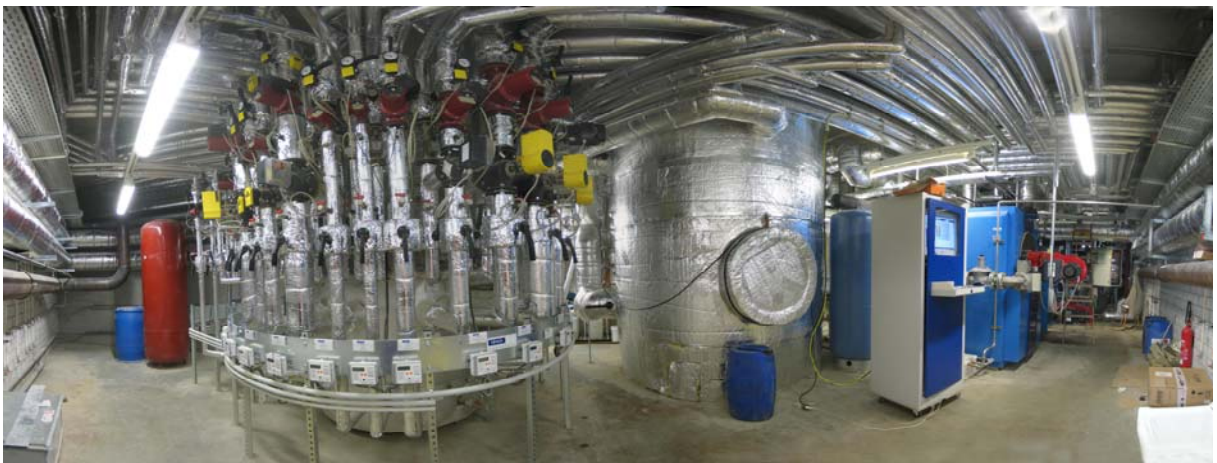
Bild A7.2: Panoramabild: Foto des Wärmeverteilers, des Warmwasserpufferspeichers und der Heizkessel (von links betrachtet)
