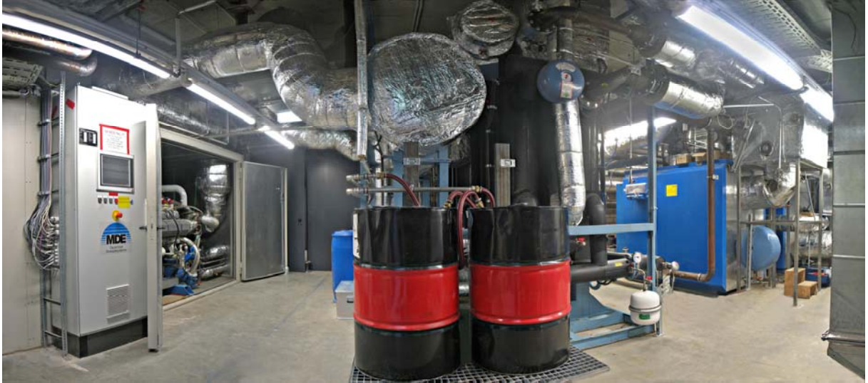
Bild A7.1: Panoramabild: Foto des Blockheizkraftwerks, der Absorptionswärmepumpe und eines Heizkessels (von links betrachtet)
