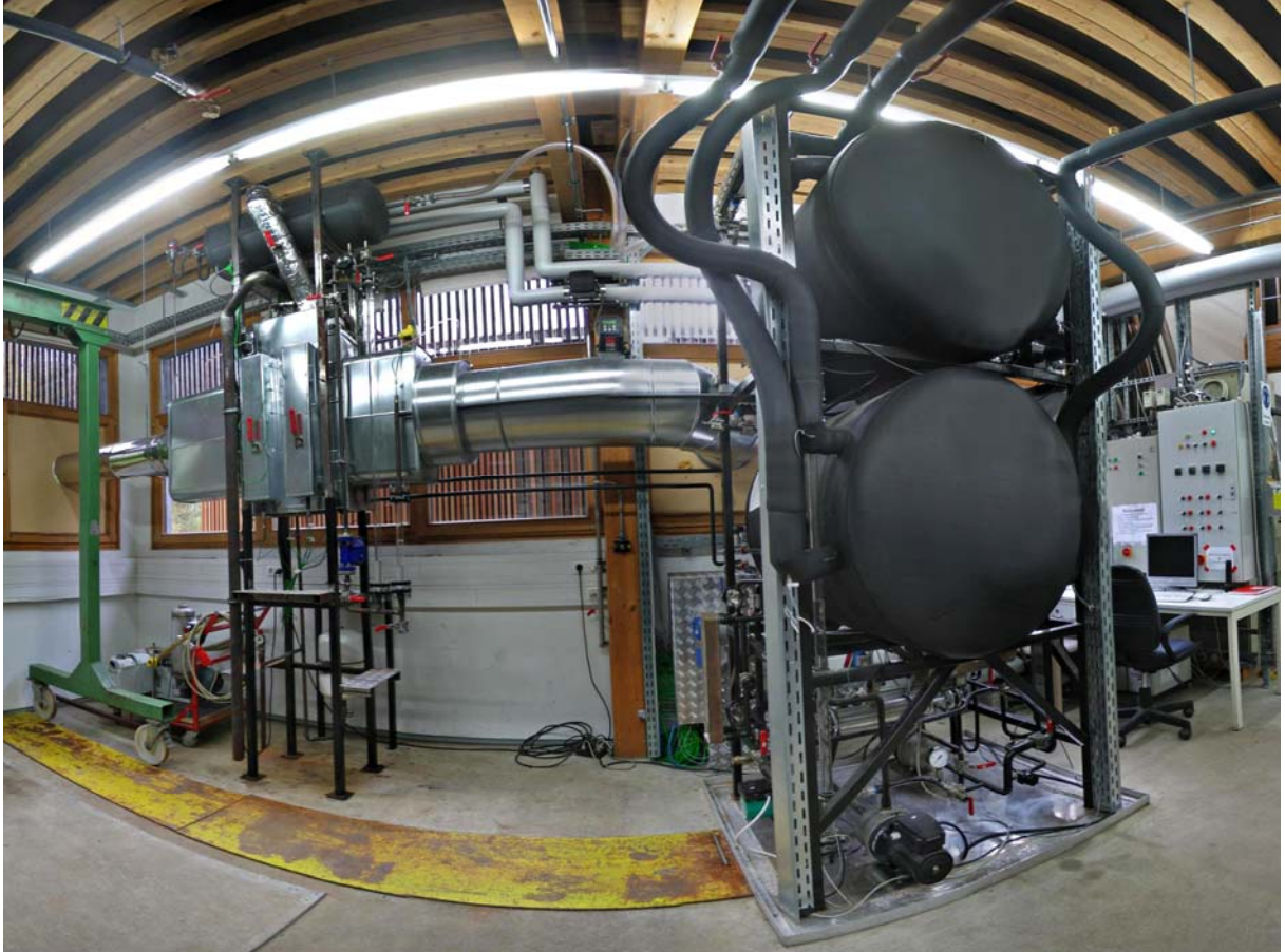
Bild A5.1: Foto der Versuchsanlage am ZAE Bayern: Prototyp einer abgasbeheizte zwei-/ einstufigen Absorptionskälteanlage
