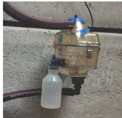
Abb. A3.25: Kippwaage für Sickerwasser aus der oberen Dränmatte (Kippvolumen 100 ml)
