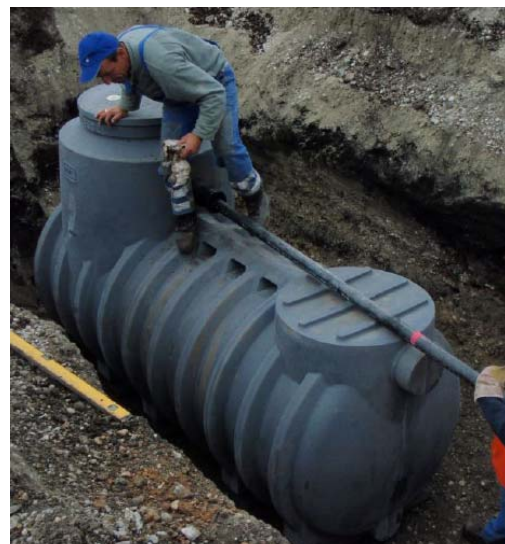
Abb. A3.27: Sickerwassertank
