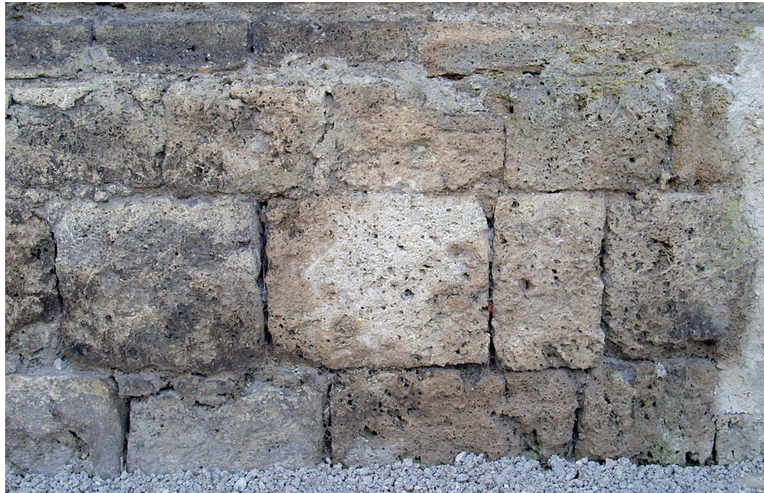
8: Prälatenstock, Kalktuffsockel mit offenen Fugen.
