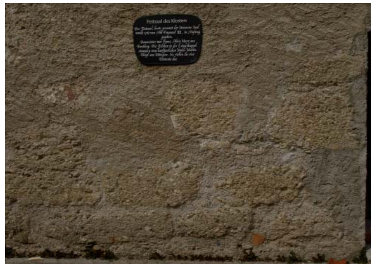
17: Das Mauerwerk des Steinernen Saals besteht aus großen Nagelfluquadern sowie aus Tuff und Ziegeln.
