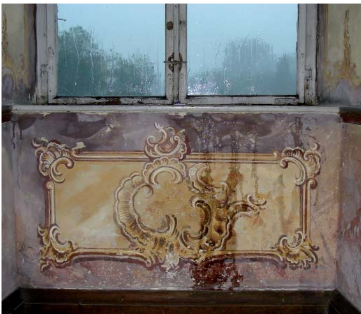
11: Westwand Fensterbrüstung, bei Schlagregen läuft das Wasser aus der Wand.
