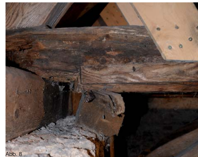
Abb. 8 Der beschädigte Zugbalken liegt nicht mehr korrekt auf der Mauerlatte auf
