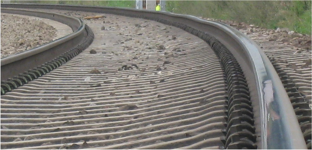
Bild. A. 13: Gleislagefehler im Anfangsbereich des Abschnitts W28 (Zw700+Skl28) (Unebenheit, Riffelbildung) – aufgenommen in regulärer Fahrtrichtung
