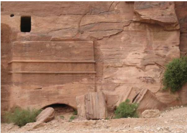
Abb. 8: Monument Nr. 831 (rechts). Einsturz infolge ebenen Gleitens entlang einer Kluft.
