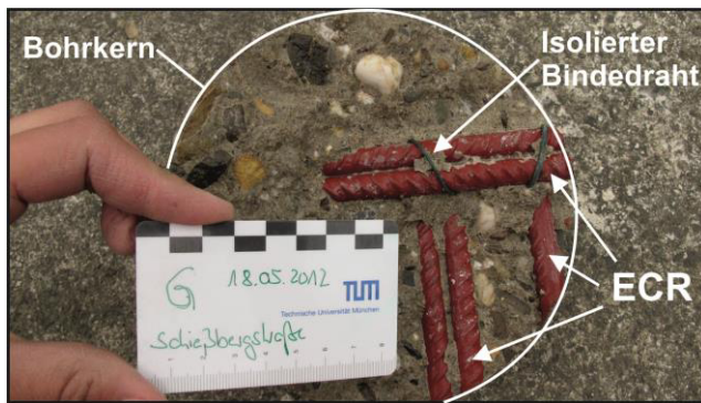
Bild 10-3: Freigelegte epoxidharzbeschichtete Bewehrung an der Bruchfläche (Unterseite) eines entnommenen Bohrkerns mit D=150 mm [ZINT14]
