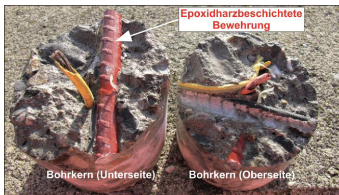
Bild 10-6: Freigelegte epoxidharzbeschichtete Bewehrung an einem vor Ort entnommenen und gebrochenen Bohrkern mit D=100 \text{ mm} [ZINT14]
