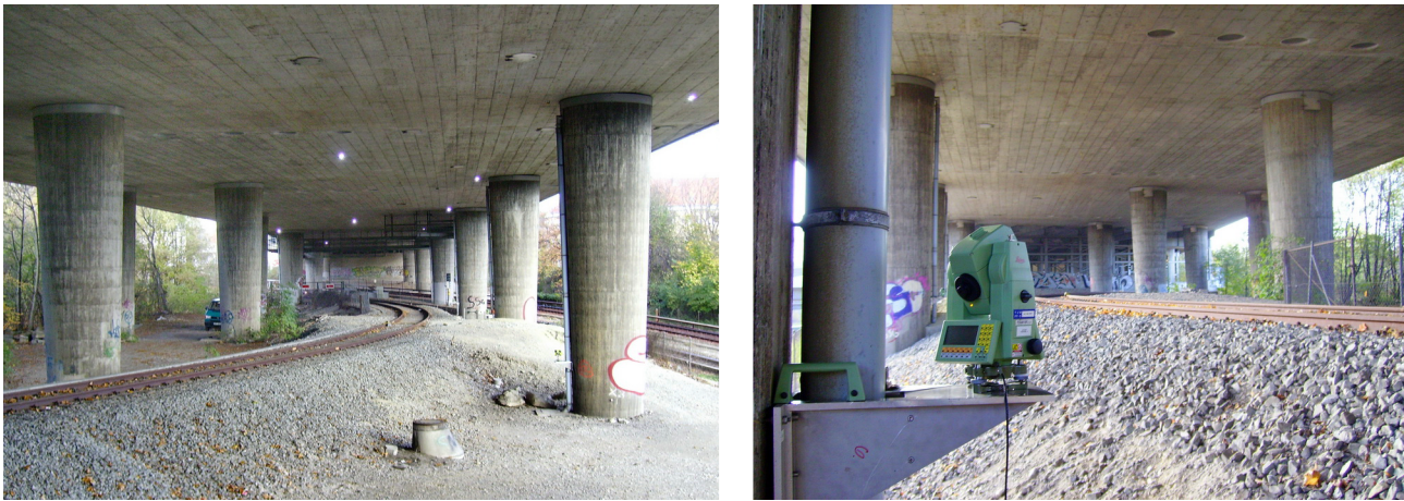
Abbildung 6.4: Deckenprismen an der Brückenunterseite (links) und berührungslose Messung der Objektpunkte von einem Konsolenstandpunkt aus (rechts)
