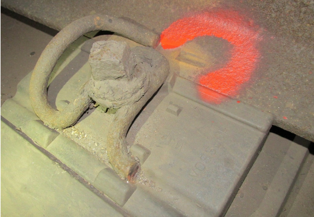
Abbildung 8.3 Beschädigte Spannklemme innerhalb des Versuchsabschnittes; Innerhalb der roten Markierung ist eine Spur der Längsbewegung des Federarmes zu sehen
