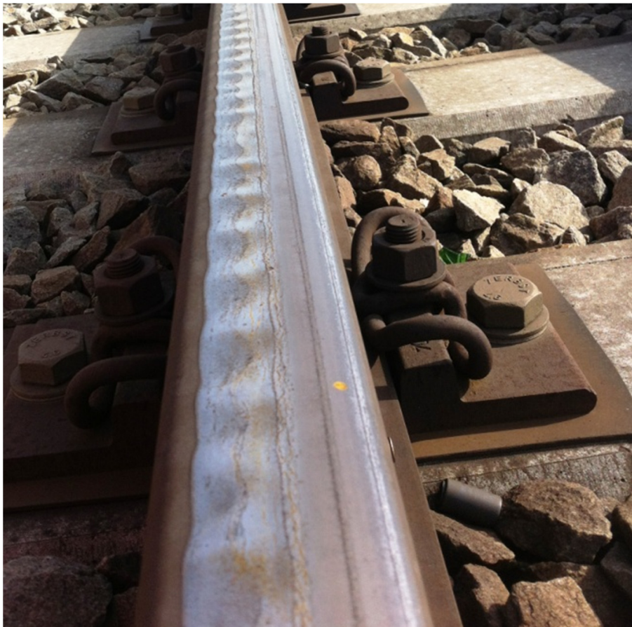
Abbildung 3.2 Wellenförmige Schienenunebenheiten entlang der Schienenlauffläche (Balfanz, DB Netz AG, o.J.)
