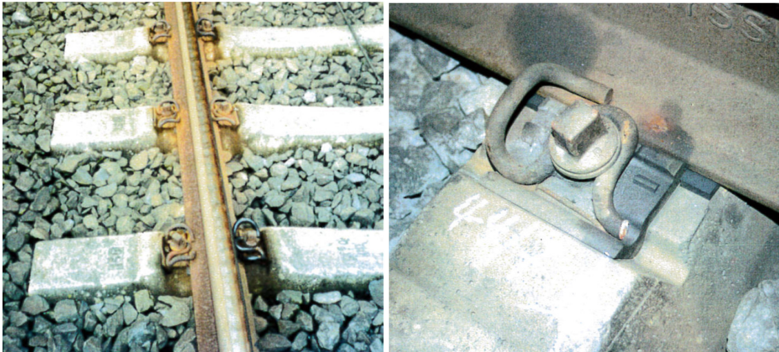
Abbildung 1.1 Links: Verriffelte Schienenoberfläche im Rauheberg-Tunnel der SFS Hannover-Würzburg; rechts: Gebrochene Spannklemme Skl 1 (Leykauf et al., 1999; Leykauf et al., 2000)
