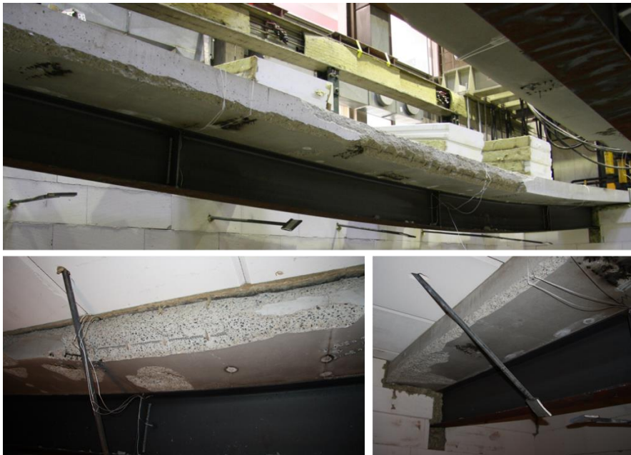
Bild 15: Abplatzungen an den Prüfkörpern nach dem Brandversuch
