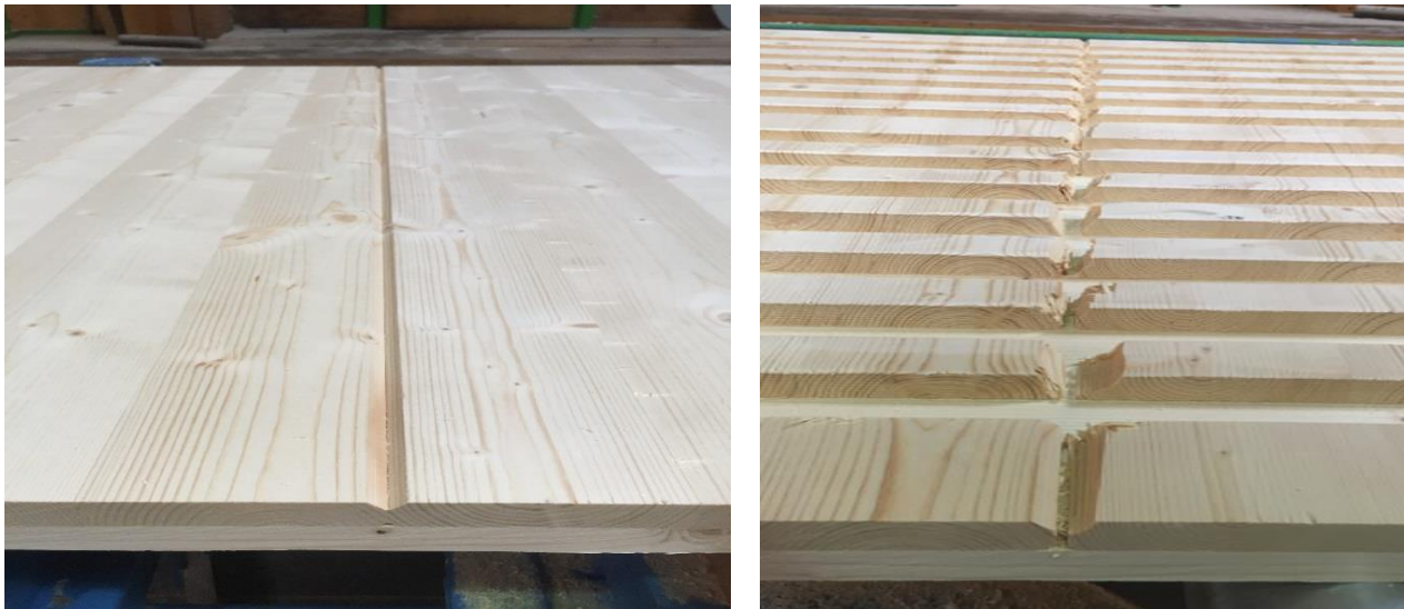
Abbildung 4.12: Gefaster und nicht verklebter Plattenstoß zwischen den Massivholzplatten der zweiten Schicht links vor und rechts nach dem Fräsen
