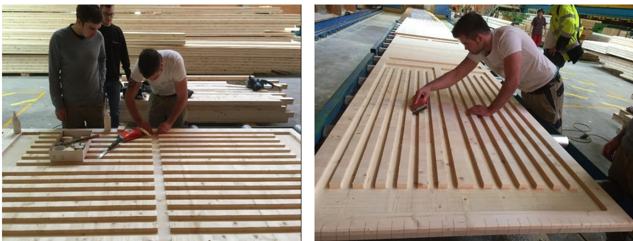
Abbildung 4.13: Bereinigen der Bruchkante und Einsetzen von Füllstücken zur Vermeidung von hydraulischen Kurzschlüssen im System
