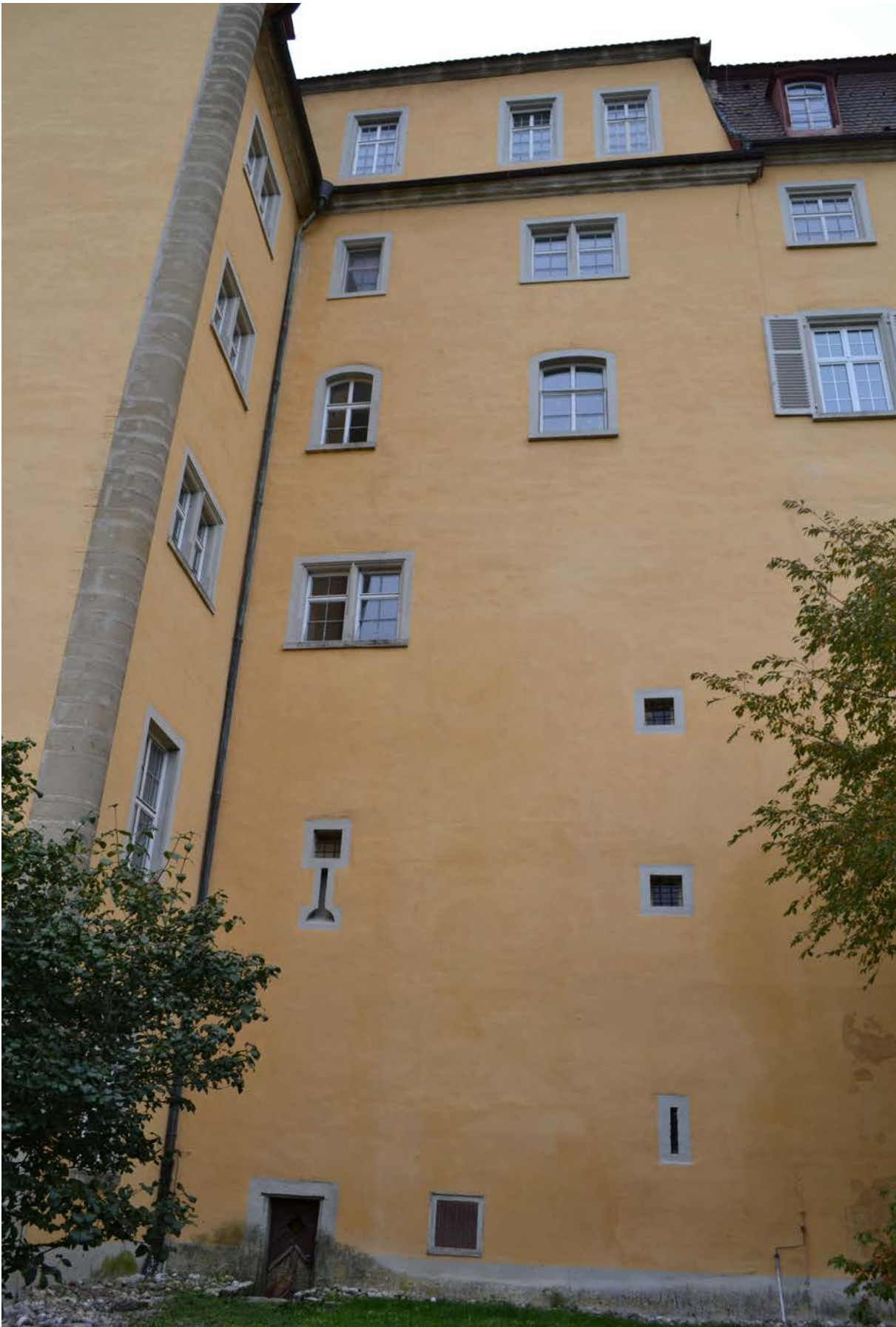
19 | Östliche Giebelwand gegen Westen mit zwei Mittelpostenfenstern aus Bauphase II in Erdgeschoss (s. VII.17) und 2. Obergeschoss, der Fensterschlitz und die zwei Rechteckfenster darüber belichten das Treppenhaus in die Gewölbe des Basteitürms Ost, Giebel auf Höhe der Mansarde in Bauphase IV.2c neu aufgeführt (a) (Okt. 2012); Detail Tür s. VII.18
