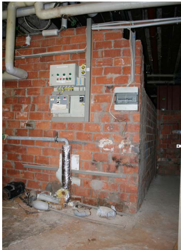
19 | 2. UG, hinterer Teil des großen Gewölbekellers (HbN-2UG02) gegen Westen, 1962 Einbau der öldichten Aufmauerung für zwei Öltanks (s. VIII.20) (Nov. 2012)
