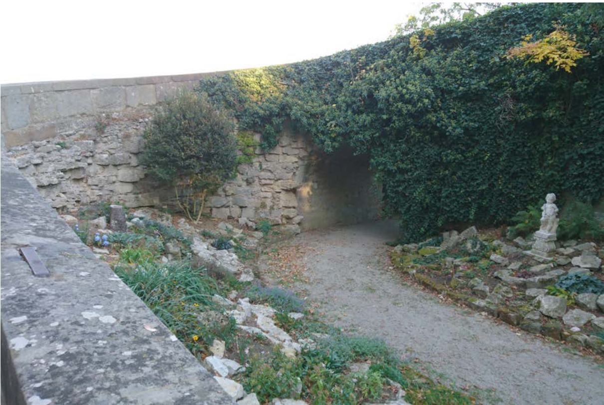
28 | Fundament des Fahrwegs aufseiten des Neuen Wegs mit Durchgang in den östlichen Grabenabschnitt (s. XII.29), gestaltet in Form einer künstlichen Ruine und somit integraler Bestandteil der englischen Gartenanlage, zu der man den Neuen Weg ab den 1780er Jahren umformen ließ, Blick gegen Osten (Okt. 2018)
