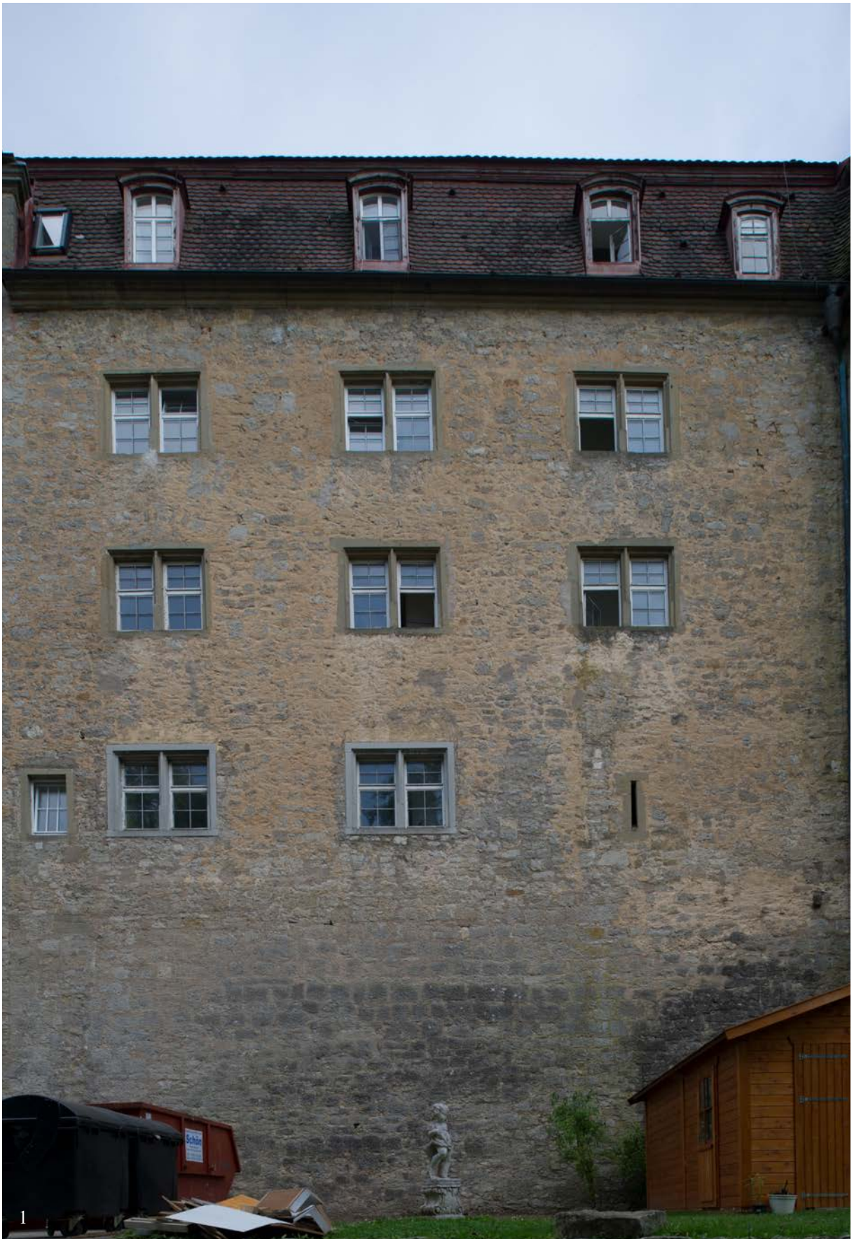
1 & 1a | Westfassade gegen Osten (Juli 2017), im Detail rechts (1a) Befundmarkierung der Burgzwingermauer in Form eines regelmäßigen Schichtenmauerwerks aus grob gespitzten Kalksteinquadern mittleren Formats, das den anstehenden Felsen bis auf Höhe des Erdgeschosses verkleidet, wohl 14./15. Jahrhundert, aufgehendes Mauerwerk in Bauphase III.1b aufgeführt (Juli 2017); Detail Baufuge gegen den Saalbau s. X.3 | © Isabel Muehlhaus TUM (bearb. LG)
