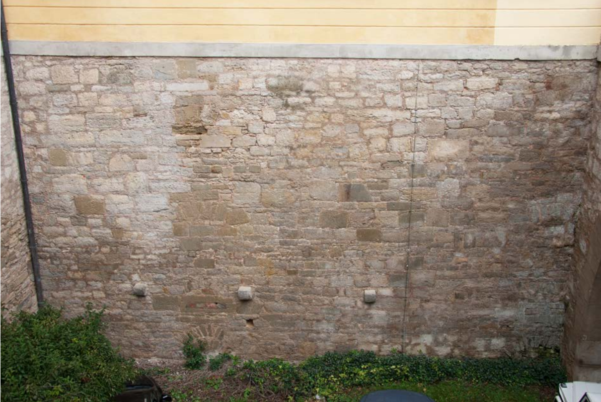
10 | Fundament westlich der Schlossbrücke, Mauscharte im westlichen Abschnitt dient als Verblendung eines Abortschachts (Detail s. VII.11), gleiches gilt für die Mauscharte im Eck am Brückenfundament (Detail s. VII.16) (Okt. 2017)
