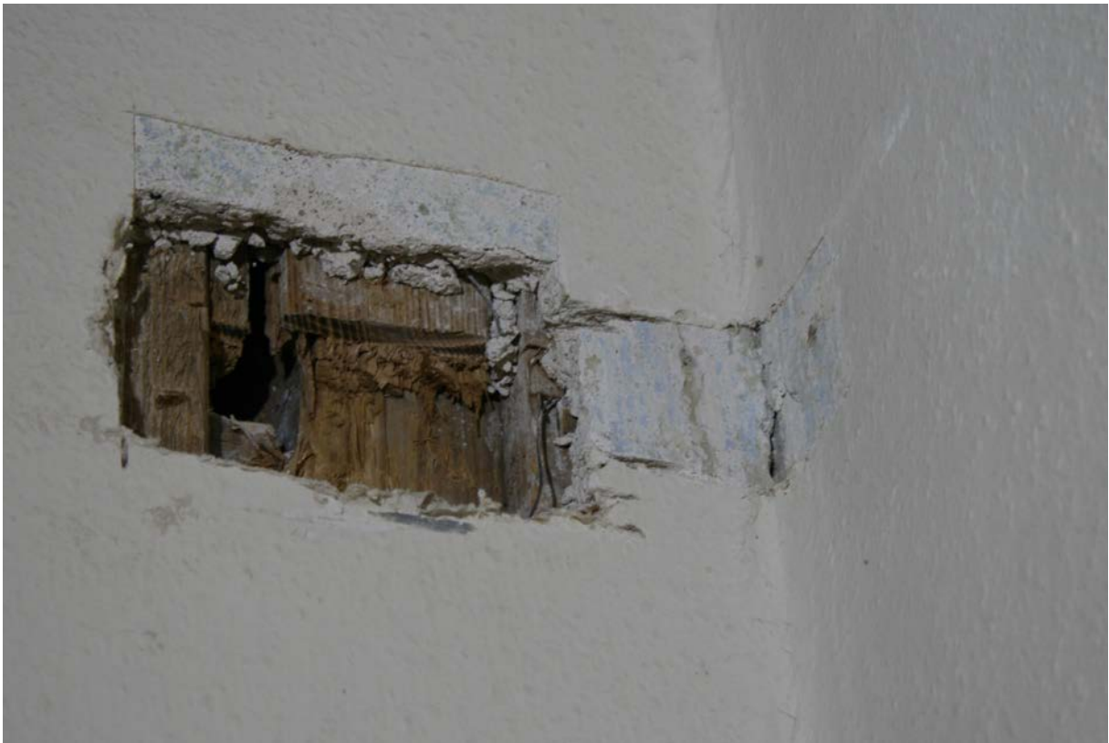
47 | Marstall, 1. Obergeschoss, Raum Ma-1OG12, Befundstelle 010 an der nachträglich eingezogenen Nordwand, Holzständerkonstruktion mit senkrechter Lattung, verputzt, geglättet und mit hellblauer Tünche dünn gefasst, darüber moderne Tapete, die zuunterst befindliche, graublau Tünche der Außenwand fehlt (vgl. XIII.43) (Nov. 2012)
