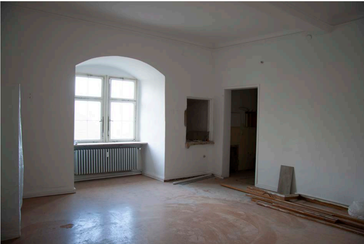
56 | 1. Obergeschoss, ehem. Nebenkammer (HbN-1OG07) zum Hinteren Stubenappartement gegen Nordosten mit historischen Stuckprofilen am Deckenanschluss (s. VIII.57) und Wandnische im Bereich eines Abortschachtes (Jan. 2018)
