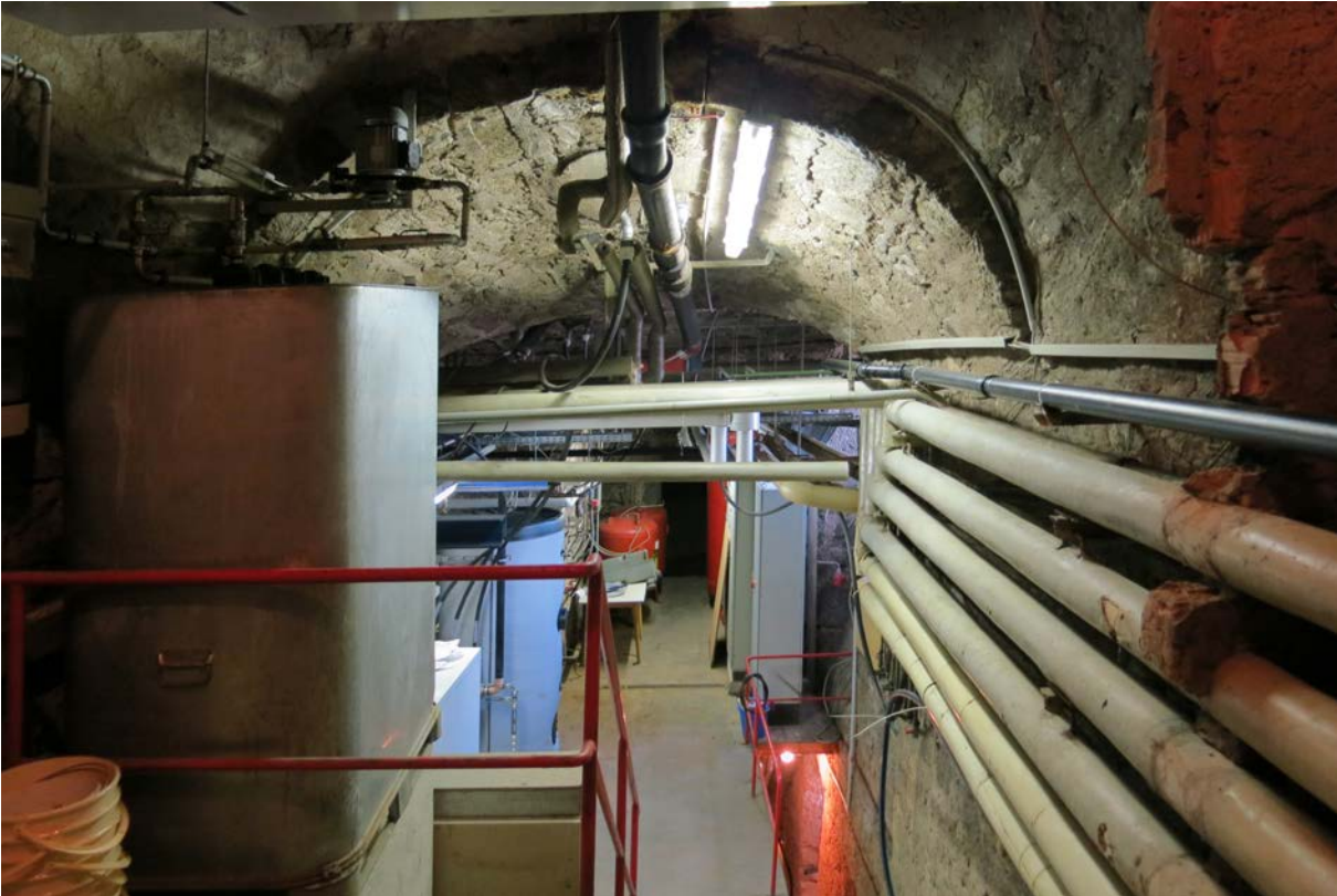
11 | 2. Untergeschoss, großer Gewölbekeller (HbN-2UG01) unter dem Saalbau, Blick vom Viertelpodest der Kellertreppe zum Turm gegen Norden (Nov. 2015)
