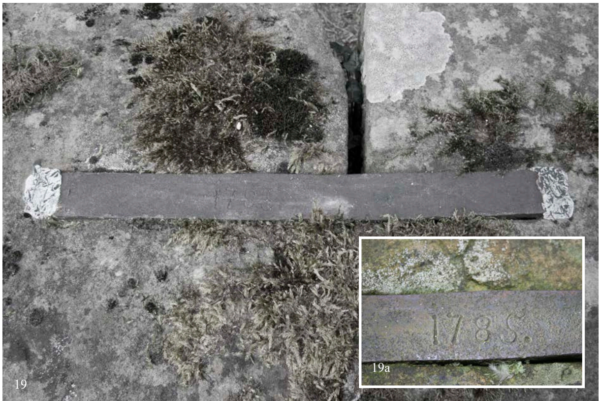
19 & 19a | Fahrweg, Eisenklammer zwischen zwei Brüstungssteinen an der Ostseite des Ruheplatzes (Juli 2017), im Detail (20a) die Gravur des Baujahrs „1785“ (März 2013)
