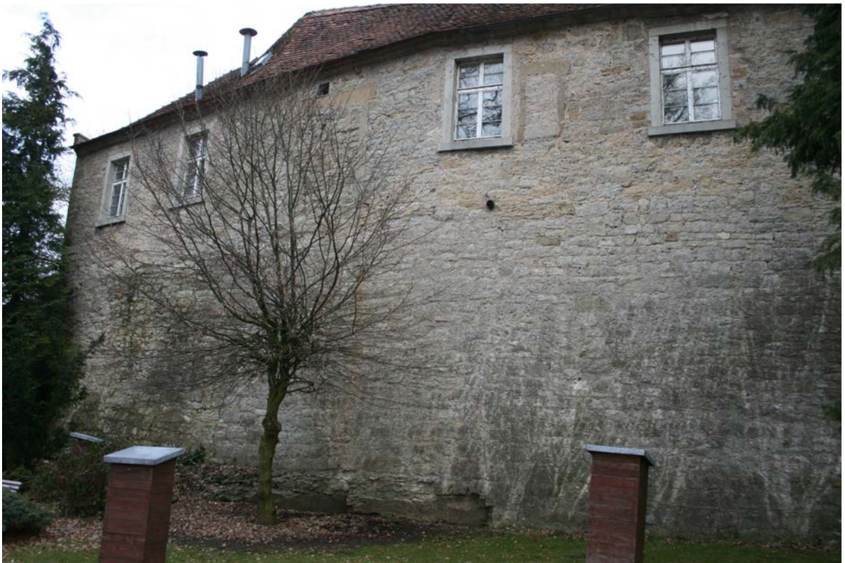
2 | Remise (re.) und Torbau (li.), Rückfassaden am Neuen Weg gegen Osten mit Blick auf die Mantelmauern am Fundament des hinteren Schlosshofs (März 2013); Mauerwerkdetails s. XII.3-5
