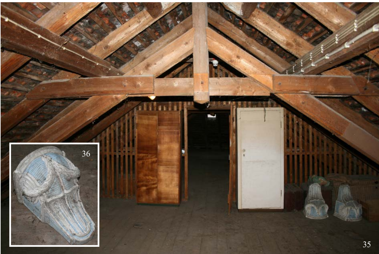
35 & 36 | 2. Dachstock über der Mansarde, Dachstuhl aus Bauphase IV.2c, Sparrendach mit liegendem Stuhl und Hängewerken, Blick gegen Süden, rechts zwei klassizistische Holzkonsolen (Detail s. IX.36) (Jan. 2013)
