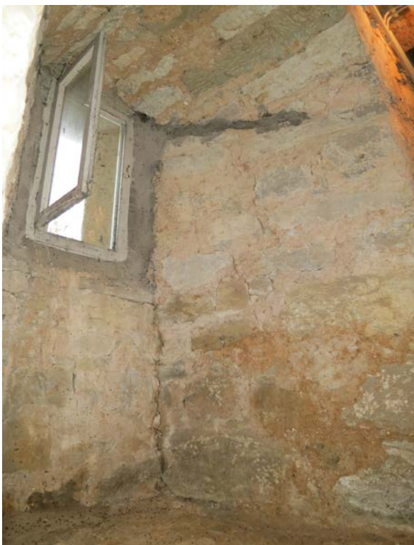
30 | 2. UG, Ostwand, (Schieß-?)Nische auf Höhe des unteren Laufs der kleinen Kellertreppe (HbN-Tr3-2UG(3UG)) gegen Südosten (Nov. 2015); Außensicht s. VIII.10
