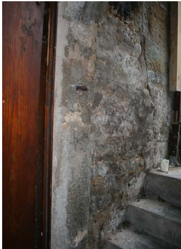
12 | 1. UG, Werksteinrahmen (Tu-1UG01-Wd-T01), südlicher Türholm, Kalkstein, grob gespitzt, mit Eiserring als Rudiment der historischen Türaufhängung (Nov. 2012)
