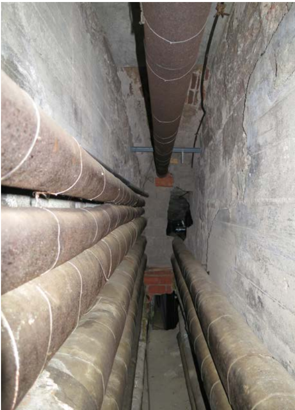
8 | 1. UG, Technikgang (HbW-1UG01) gegen Norden, 1954 angelegt, im Hintergrund Wandausbruch am Gewölbe des Saalbaukeller (Nov. 2015); Details Seitenwände s. X.9 & 10
