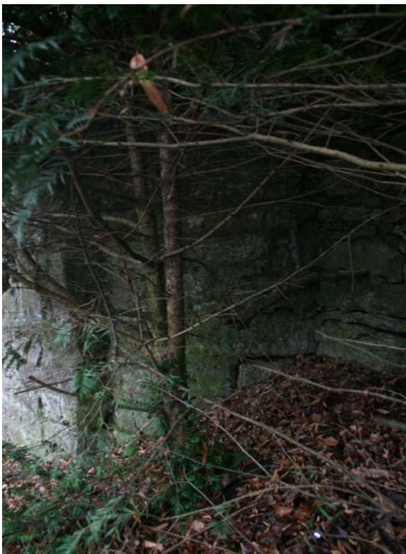
26 | Abgerundete Ecke am nordwestlichen Rücksprung der barocken Terrassierung, die die mittelalterliche Eckbastion überbaut (Jan. 2013); vgl. Grundriss von um 1760 (XII.41)
