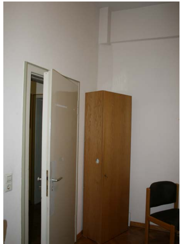
20 | EG, ehem. Kammer (HbO-EG10) gegen Nordwesten mit verkleideter Balkenkonstruktion, möglicherweise handelt es sich um die bauzeitliche Holzsäule nebst Deckenbalken aus Bauphase IV.1b
