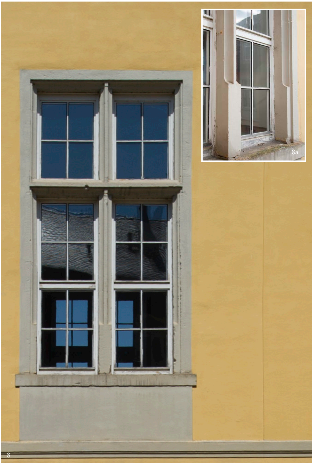
8 & 8a | 2. Obergeschoss, Südfassade, mittleres Kreuzstockfenster (HbN-S-2OG-F02) am Saal, Werksteinrahmen Typ C (Taf. XV) aus Bauphase III.1b mit Hohlkehle und einseitig gekehltem Auslauf (s. Detail VIII.8a | Jan. 2018), Sandstein, Brüstungsfeld in Bauphase IV.2c ergänzt (Juli 2017) | © Isabel Muehlhaus TUM
