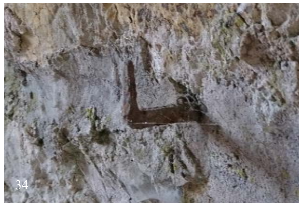
33 & 34 | Schmiedeeiserne Schlaufe (33) und schmiedeeiserner Haken (34) an der mutmaßlichen, sekundär zugesetzten Öffnung (Zugang ehem. Eiskeller?) (Okt. 2018); Gesamtansicht s. XII.31
