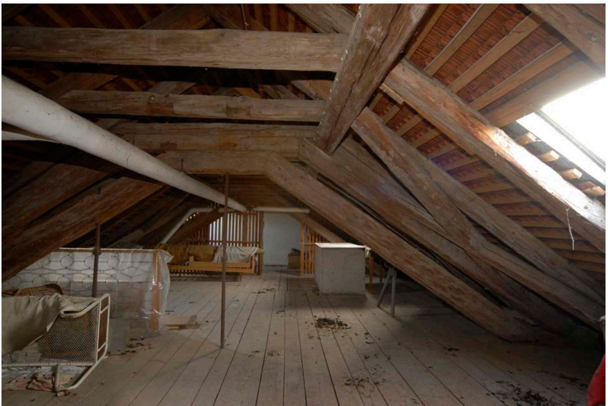
54 | Marstall, 2. Dachgeschoss gegen Süden, Kehlbalkendach mit liegendem Stuhl aus Bauphase IV.2a (Jan. 2012)
