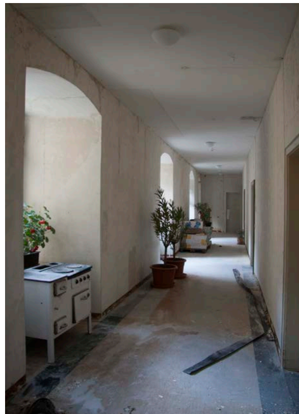
53 | 1. OG, Flur (HbN-1OG01) längs der Südseite gegen Westen, 1954/61 überformt und Decke abgehängt (Jan. 2018); Detail historische Decke s. VIII.54
