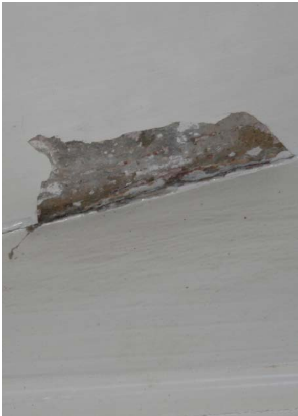
64 | 2. OG, ehem. Abort (HbW-2OG05), hell- und dunkelrote Farbreste unter Putz im Laibungsbogen der Fenster- nische (HbW-W-2OG-F03) (Jan. 2013); Gesamtansicht mit Befundmarkierung (blauer Rahmen) s. X.62
