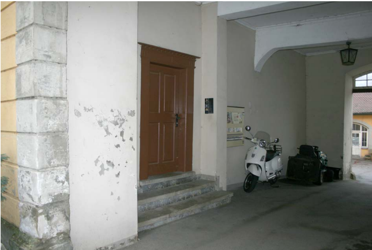
39 | Erdgeschoss, Durchfahrt (HbN-EG00) gegen Nordwesten, Ostwand (Fachwerk aus Bauphase III.1b oder III.3), links Eingang (HbN-EG01-Wb-T01) in den westlichen Gebäudeteil mit historischem Türrahmen (s.VIII.40) wohl aus Bauphase III.3 (3. Viertel 17. Jh.) (Jan. 2013)
