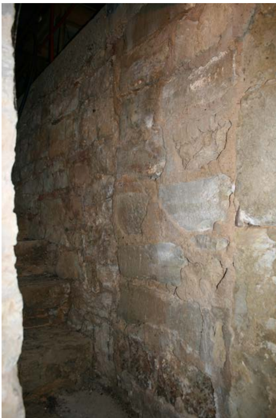
27 | 2. UG, Innenwand der kleinen Kellertreppe (HbN-Tr3-2UG(3UG)) gegen Südwesten, Blick auf zwei Baufugen, die den ehemals wohl abgewinkelten oberen Lauf begrenzen, nebst zwei seitlich armierten Eisenkloben (Details s. VIII.28 & 29), Zusetzung wohl vor 1944 (Jan. 2013)
