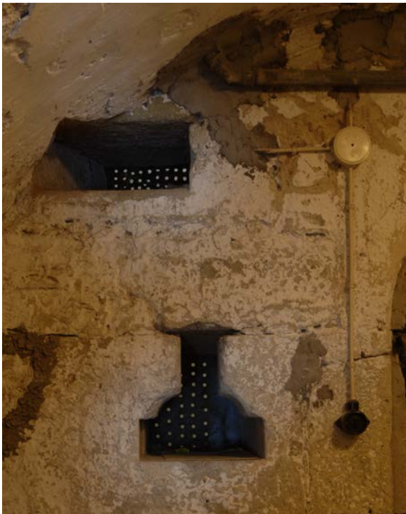
63 | Witwenbau, Nordwand der ehem. „Metzlerkammer“ (Wi-1UG02), seitliche Öffnungen westlich der Eingangstür legen temporäre/alternative Nutzung des Raums als Gefängnis nahe (nachweislich u. a. während Bauphase III.3), Durchreiche (?) unten entspricht ehem. Steigbügelscharte, oben Luftscharte (?) (Jan. 2012)
