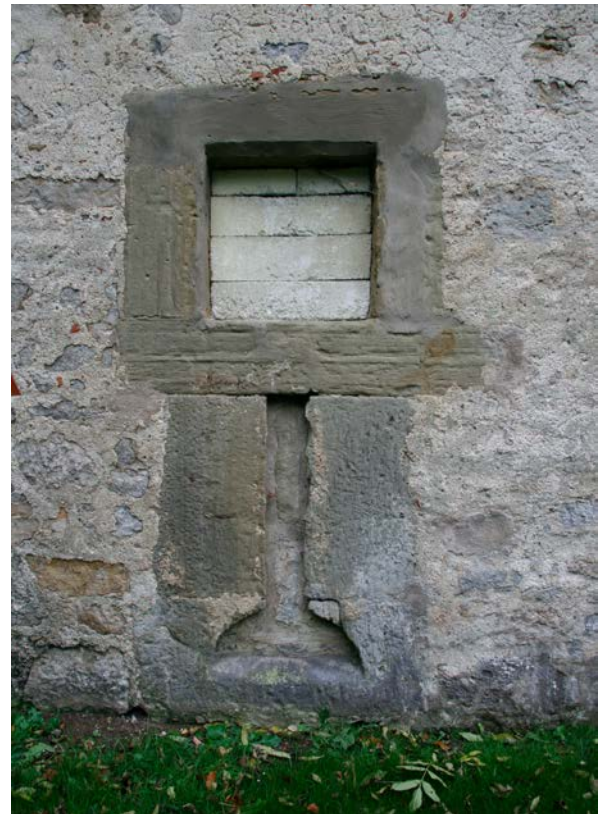
25 | Basteiturm West, Westfassade, 2. UG, nördliche Steigbügelscharte mit Beobachtungsfenster, Sandstein, sekundär zugesetzt (Okt. 2017)
