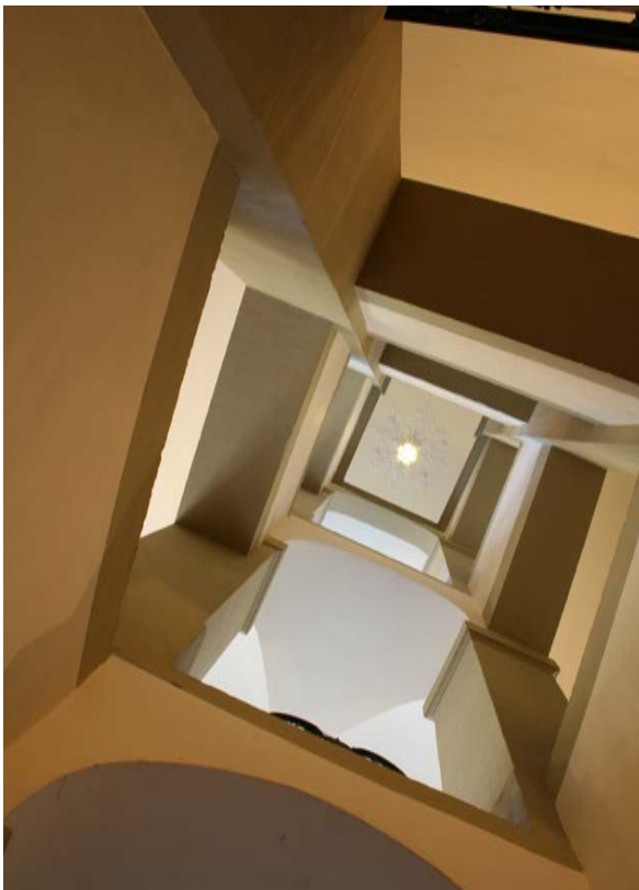
23 | Treppenaugie des barocken Treppenhauses aus Bauphase IV.2c, Blick vom Erdgeschoss zum Deckenplafond mit Stuckrosette (s. X.24) (Nov. 2012)
