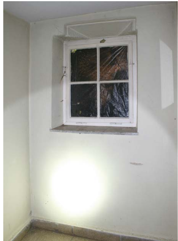
37 | 1. UG, kleiner Keller (HbN-1UG03), ehem. Schießnische (HbN-W-1UG-F02) in der Westwand, wohl in Bauphase III.1b angelegt, im 20. Jh. überformt (Nov. 2012); Außenansicht s. VIII.9
