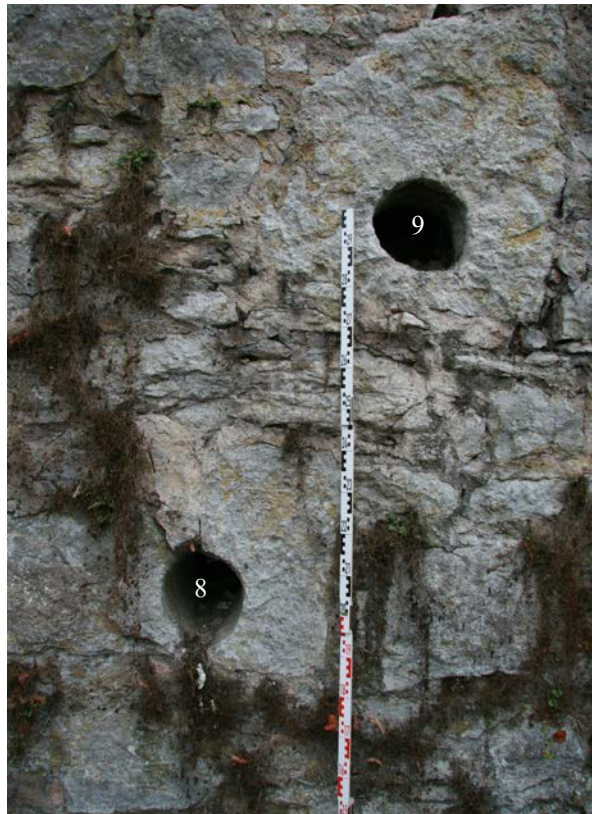
67 | Schlossgrabenmauer, Befundstellen 8 und 9: Zwei Kugelscharten je mit zugesetzten rückseitigen Schießnischen, untere Kugelscharte (Befundstelle 8) wohl aus ehem. Schlitzlochscharte gebildet (Okt. 2017)
