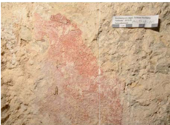
37 | EG, Ostwand am ehem. Schießstand (HbW-EG08), Befundstelle 013, Schichtenfolge: Stein, Gelb, Gelb, Putz, Rot (Sept. 2016); Befundstellenmarkierung s. X.36 (blauer Pfeil) | abgeb. in FELDTKELLER 2016
