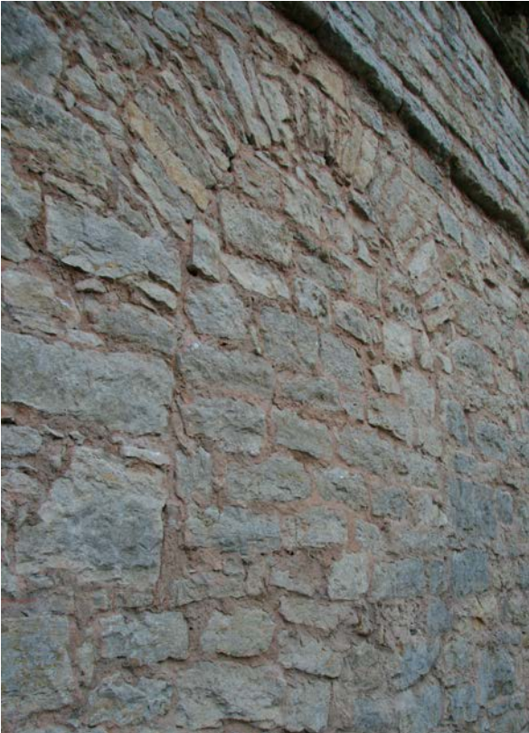
74 | Schlossgrabenmauer, Befundstelle 16: Ehem. Rundbogenöffnung, die zur Bauzeit möglicherweise als Durchlass fungierte und noch im Rahmen der Fertigstellung der Mauer geschlossen wurde (Dez. 2016)
