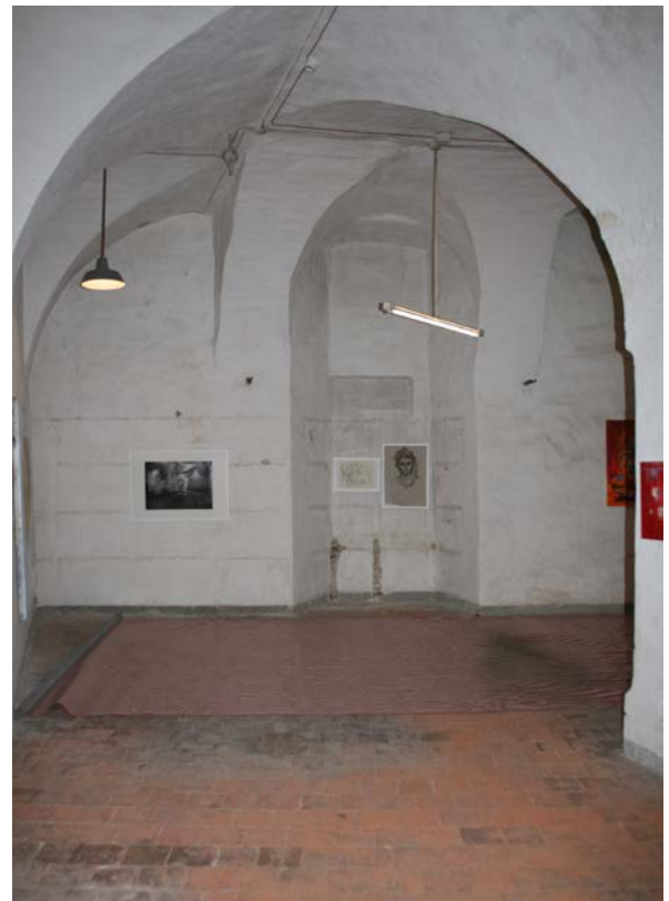
82 | Basteiturm Ost, 1. UG gegen Süden mit Blick auf den ehem. Schießstand, Öffnungen beim Bau des Kommunikationsbaus in Bauphase IV.3 zugesetzt (Jan. 2013)
