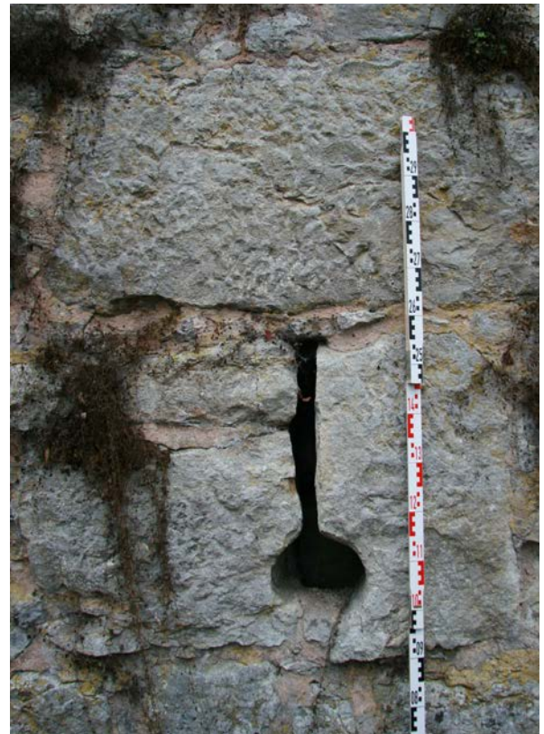
71 | Schlossgrabenmauer, Befundstelle 13: Schlüssel-lochscharte mit rückseitiger Schießnische (zur Bauzeit zugesetzt), wohl aus Spolien gebildet (Dez. 2016)
