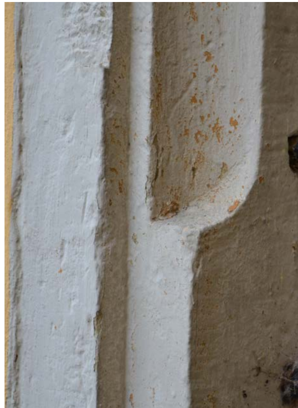
23 | EG, Westwand, Fenster (Tu-W-EG-F01), Detail Auslauf an der linken Seite des Werksteinrahmens aus Bauphase III.1b (Okt. 2012); Gesamtansicht s. XI.22
