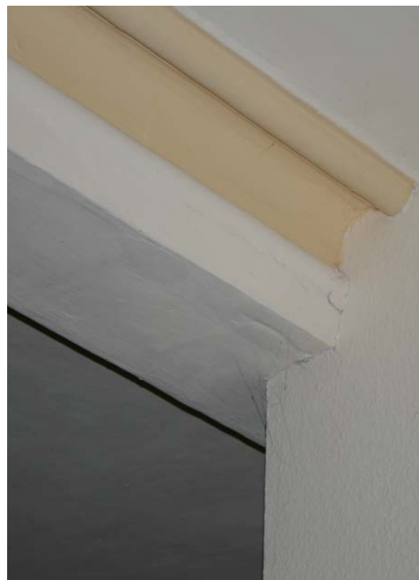
60 | 1. OG, ehem. Nebenkammer (HbN-1OG08) zum Hinteren Stubenappartement, Detail Unterzug mit historischem Deckenstück, wohl 17./18. Jh., beim Einbau des Sanitärraums (HbN-1OG08a) nach 1961 überformt (Jan. 2013); s. auch VIII.57
