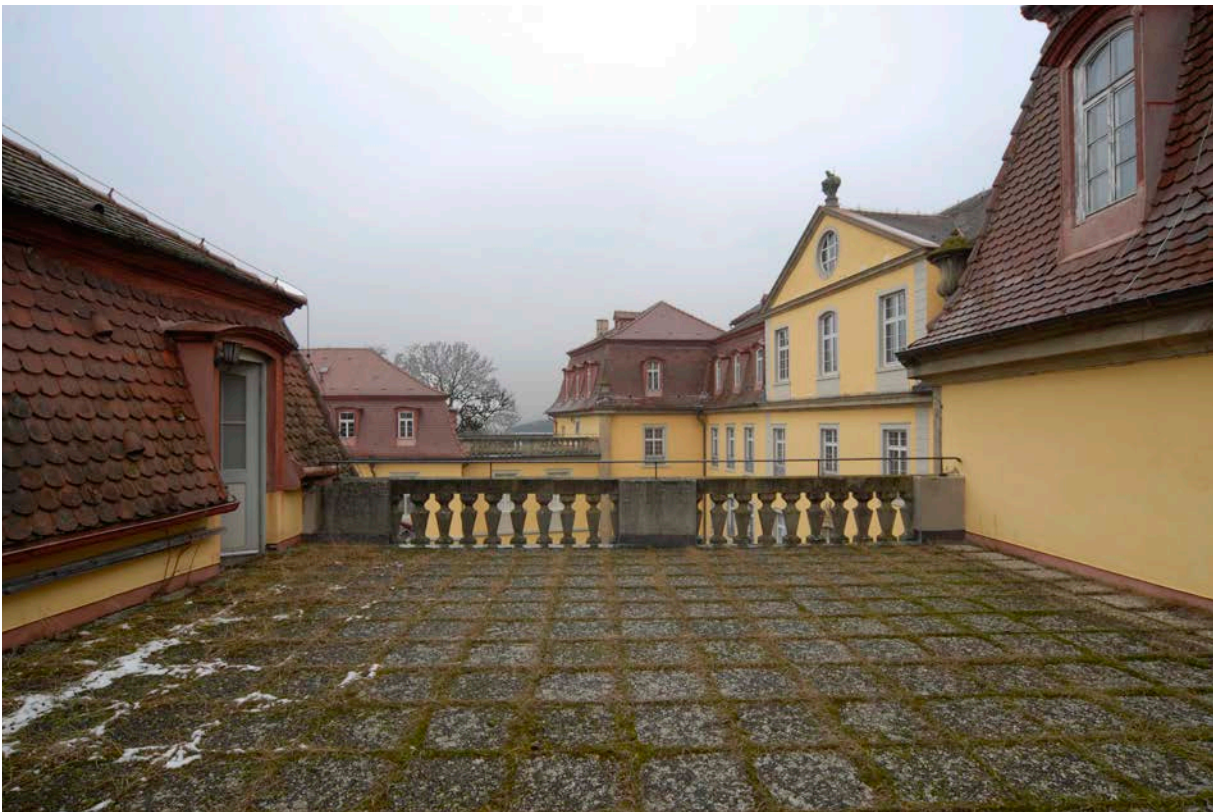
9 | Dachterrasse über dem Kommunikationsbau Ost gegen Nordwesten mit Blick auf die barocke Dachlandschaft über vorderem Schlossbau, Basteiturm West, Kommunikationsbau West und Marstall, links Zugang (Wi-1DG01-Wa-T01) in die Mansarde des Witwenbaus (März 2012)
