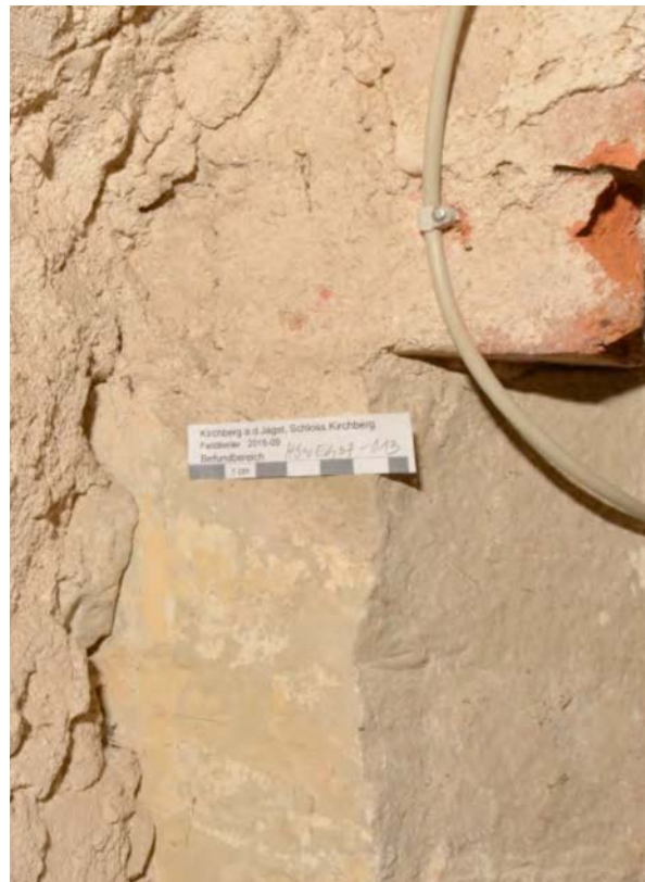
34 | EG, Durchgang HbW-EG08-Wb-T01, Detail Rückseite nördlicher Türstock, Schichtenfolge Befundstelle 010: Stein, Gelb, Gelb (Sept. 2016); Gesamtansicht s. X.33 | abgeb. in FELDTKELLER 2016
