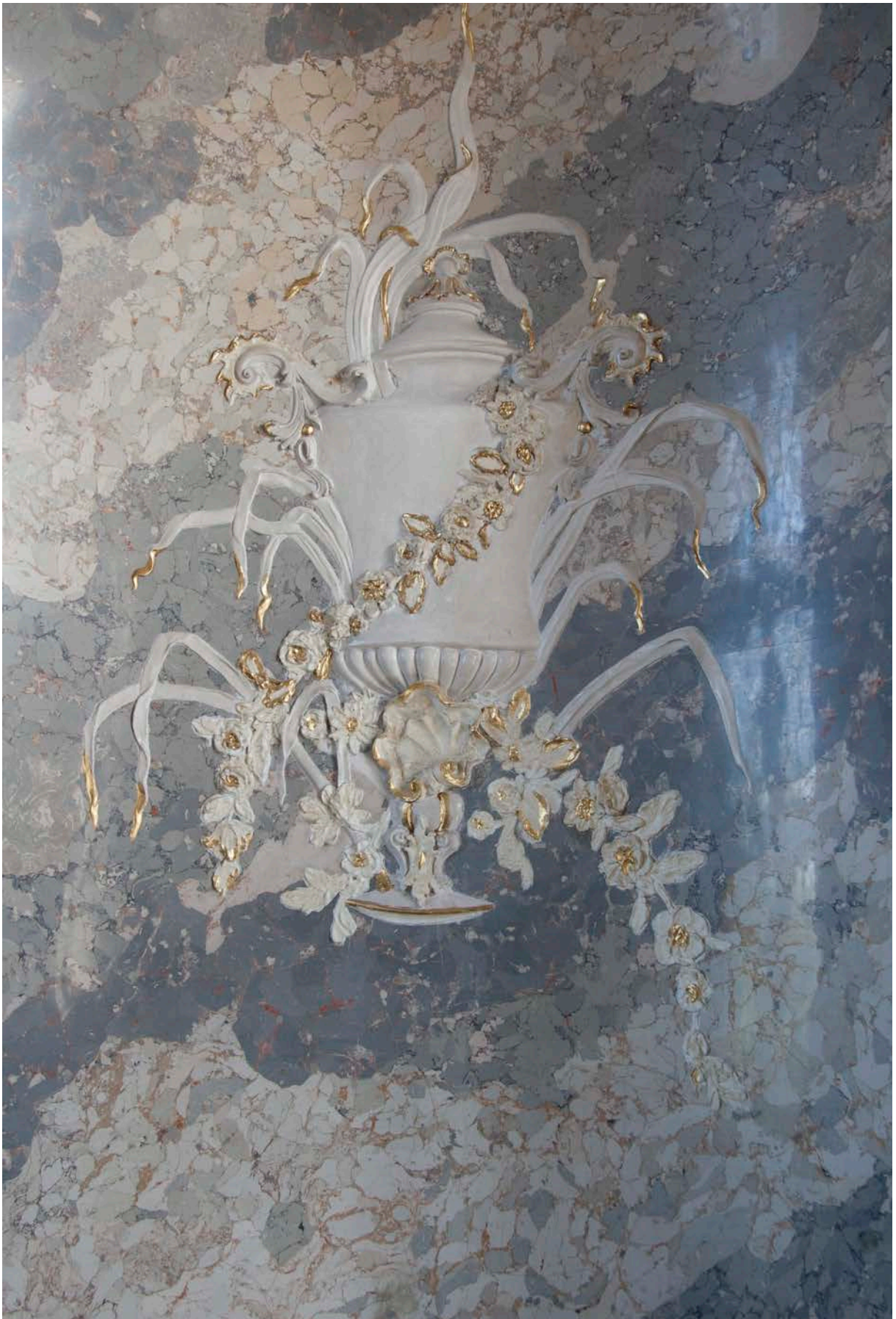
70 | 2. Obergeschoss, Saal (HbN-2OG01), Stucknische der Ostempore, 1745 in Bauphase IV.2b von dem Dinkelsbühler Stuckateur Johann Georg Pfitz (Juli 2017); Gesamtansicht s. VIII.64
