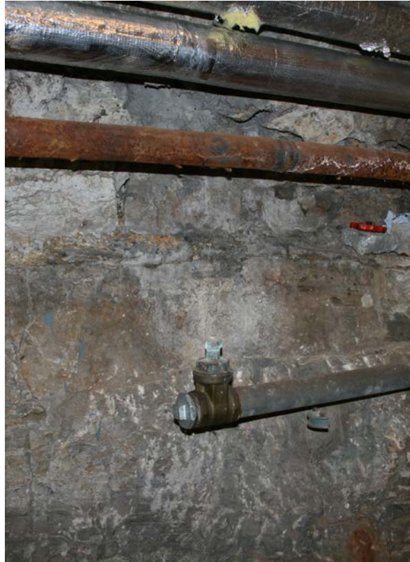
24 | 2. UG, großer Gewölbekeller (HbN-2UG02), Detail Südwand, zuunterst: grob gespitzter, anstehender, Felsen, wohl in Bauphase I.1 abgearbeitet, darauf: Gewölbefuß aus Bauphase III.1b (Nov. 2012); vgl. VIII.22
