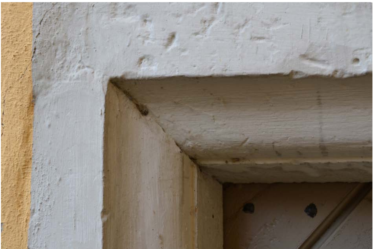
21 | Erdgeschoss, Eingangstür (Tu-EG01-Wd-T01), Detail Karniesprofil an der oberen linken Ecke des Werksteinrahmens aus Bauphase III.1b (Okt. 2012); Gesamtansicht s. XI.19
