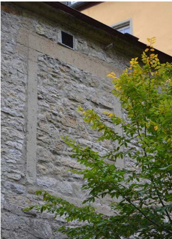
6 | Remise, ehem. Ladeöffnung aus Bauphase IV.2c zum Aufziehen von Baumaterial, nach Abschluss der Bauarbeiten i. J. 1758 zugesetzt (Okt. 2012)
