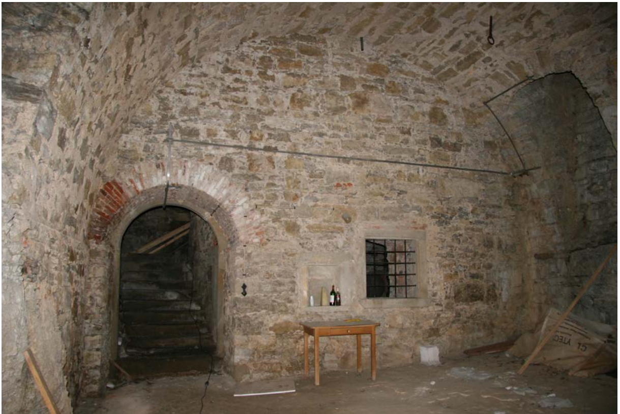
78 | Witwenbau, 2. Untergeschoss, großes Kellergewölbe (Wi-2UG01) gegen Süden, links Durchgang (Wi-2UG01-Wc-T01) ins Treppenhaus, rechts vergittertes Fenster (Wi-F-2UG02) zum ehem. Weinkeller (Okt. 2015)
