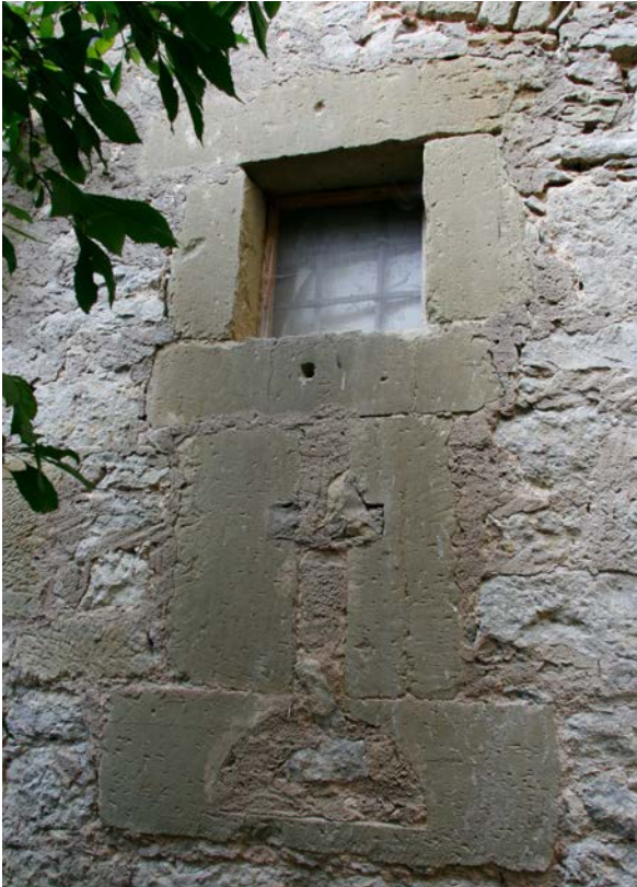
32 | Basteiturm West, Ostfassade, 2. UG, südliche Steigbügelscharte mit Kreuzschlitz und Beobachtungsfenster, Sandstein, sekundär zugesetzt (Okt. 2017)
