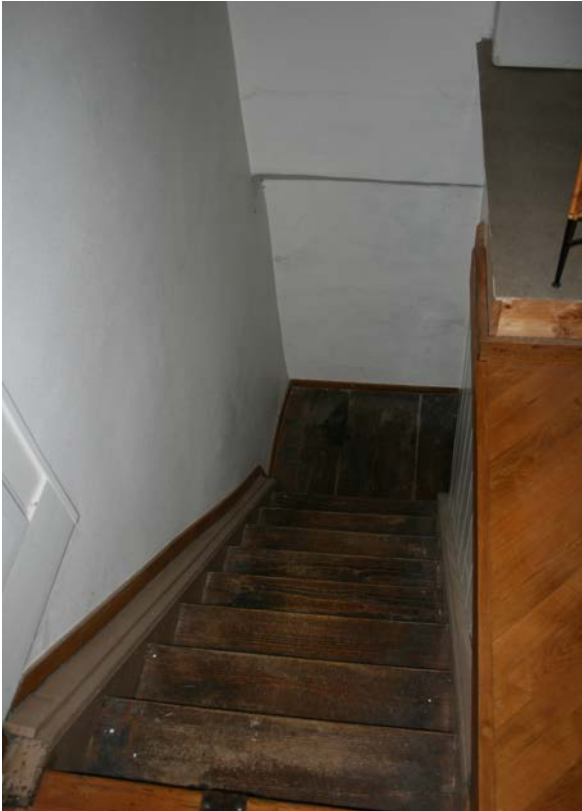
37 | 1. OG, Flur (Tu-1OG01) gegen Norden, oberer Lauf der zweiläufigen Winkeltreppe mit Halbpodest (Tu-Tr1-EG(1OG)), Treppenloch in Bauphase III.3 eingebrochen (Nov. 2012); unterer Lauf s. XI.29
