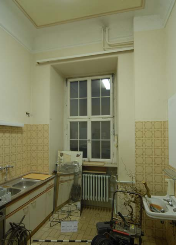
44 | Marstall, 1. OG, Raum Ma-1OG12 gegen Osten, Deckenanschluss mit historischen Stuckprofilen längs der Voute, 18./19. Jh. (Jan. 2012)
