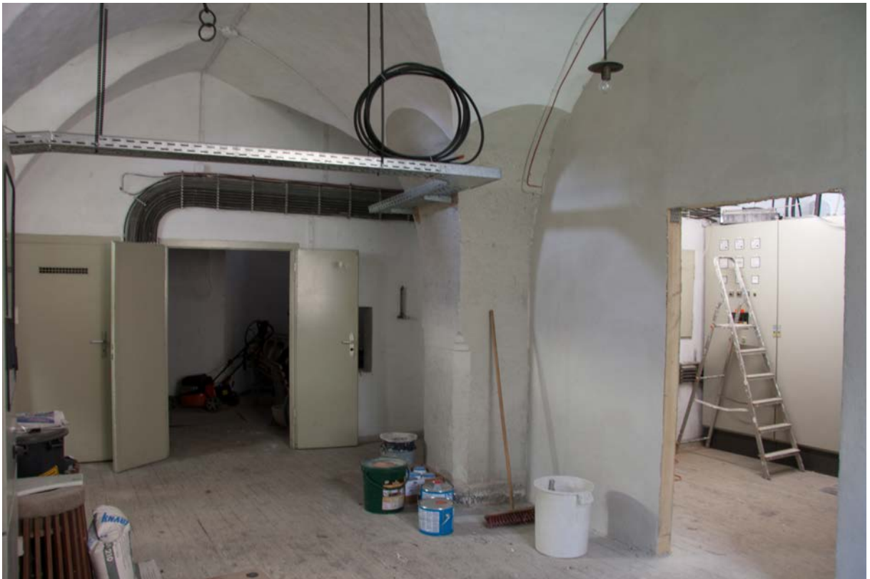
86 | Basteiturm Ost, 2. Untergeschoss, ehem. Gewölbekeller (BaO-2UG01) gegen Südwesten, im 20. Jahrhundert in zwei Kammern unterteilt (Okt. 2017)
