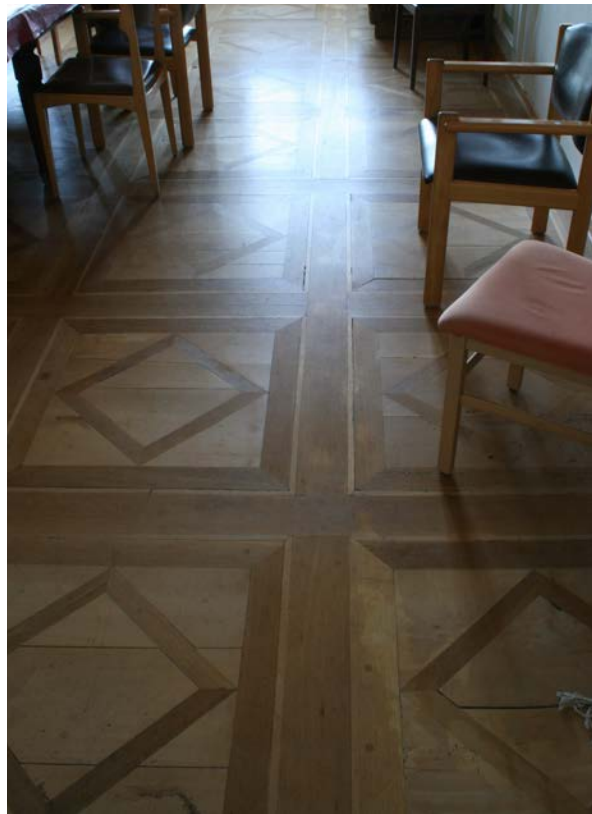
22 | 1. OG, ehem. Vorgemach (HbO-1OG05), bauzeitliches Tafelparkett mit Rautenmuster vom Kirchberger Schreinermeister Heinrich Georg Wex, 1708 (Nov. 2012)
