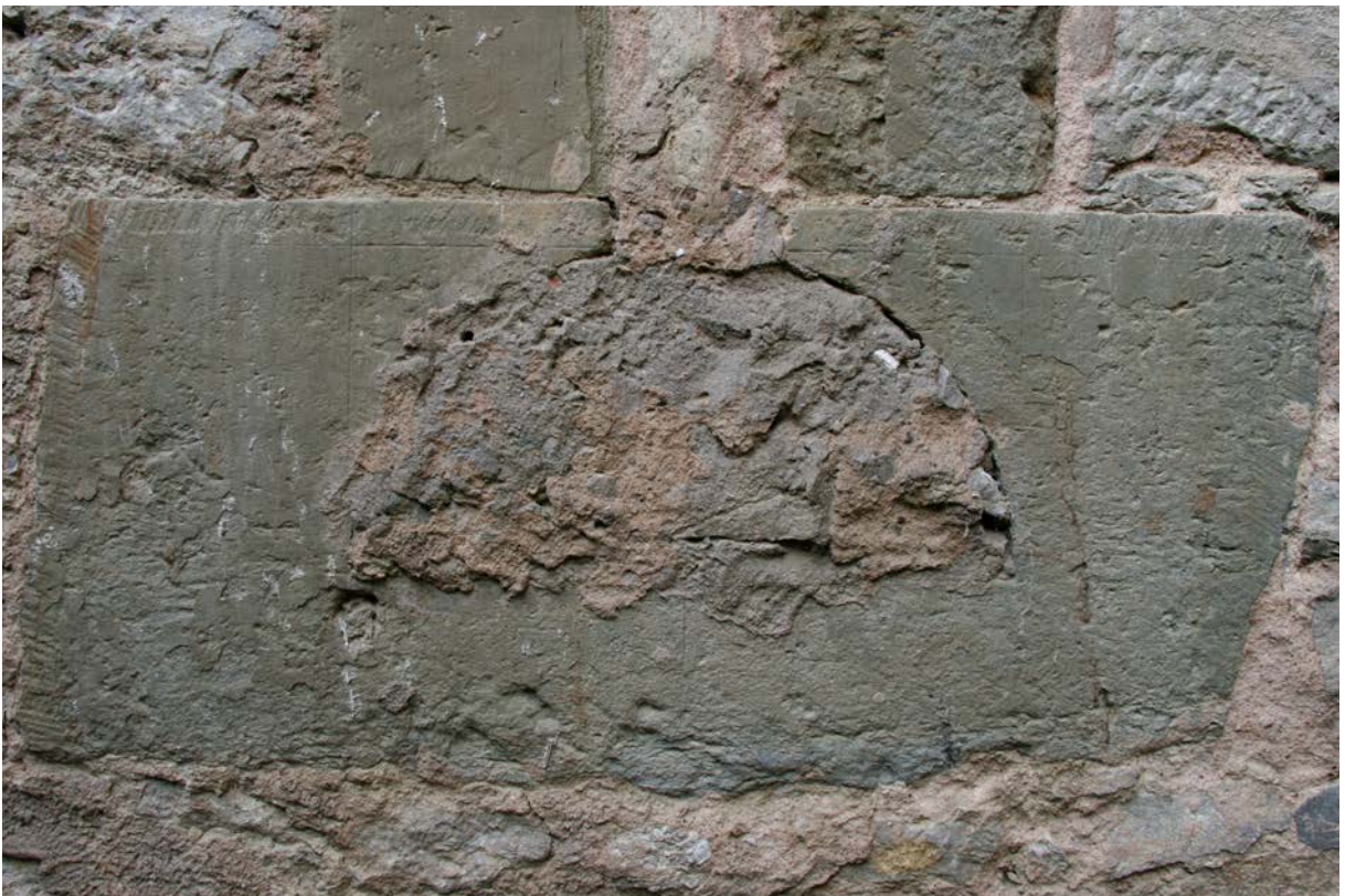
34 | Basteiturm West, Ostfassade, 2. Untergeschoss, Werkstein-Detail der nördlichen Steigbügelscharte mit Reißlinien des Steinmetzen (Okt. 2017); Gesamtansicht s. VII.33
