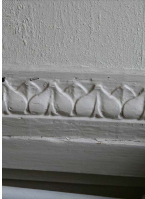
103 | 2. OG, ehem. Gelbe Stube (HbS-2OG04), Detail Blattfries an der klassizistischen Sockellamperie von 1806 im Bereich der Fenstermitte (Jan. 2013); Gesamtansicht s. VII.101
