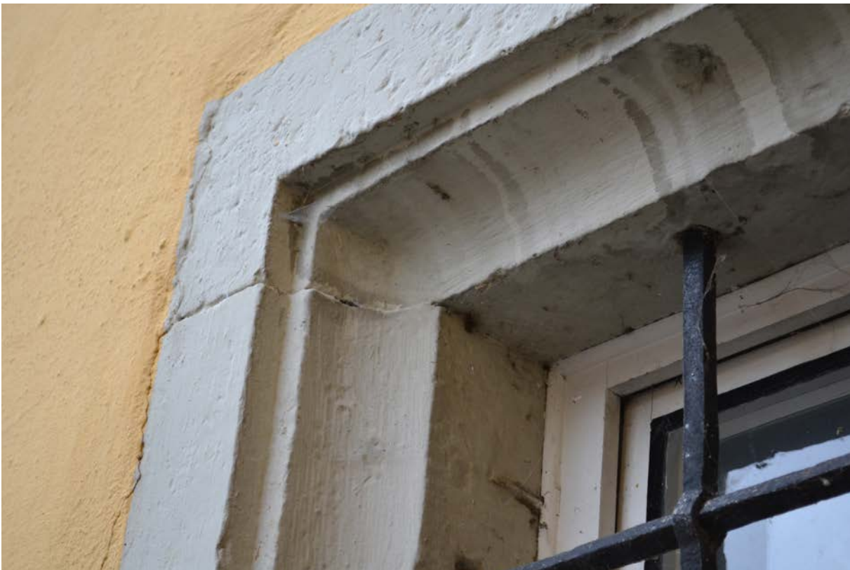
24 | Erdgeschoss, Westwand, Fenster (Tu-W-EG-F01), Detail Hohlkehle an der oberen linken Ecke des Werksteinrahmens aus Bauphase III.1b (Okt. 2012); Gesamtansicht s. XI.22
