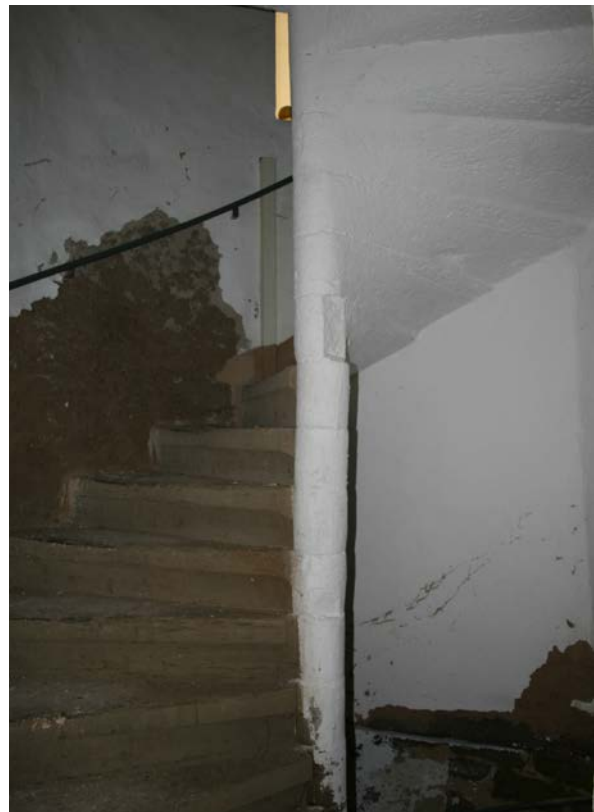
60 | Basteiturm West, Kellertreppe (BaW-Tr1-EG(2UG)) zw. 1. und 2. UG, Spindel aus Bauphase II, oberer Abschluss und Ausgang 1954 verändert (Jan. 2013)
