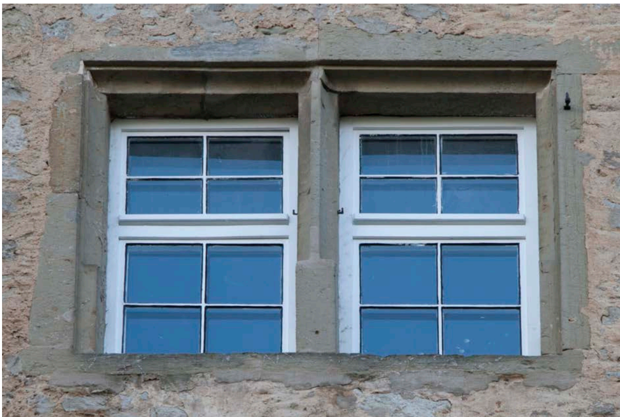
6 | Westfassade, Fenster HbW-W-1OG-F04 aus Bauphase III.1b, Mittelpostenfenster, Werksteinrahmen Typ C (s. Taf. XV) mit Hohlkehle und einseitig gekehlten Auslauf, Sandstein (Jan. 2018); vgl. u. a. XI.22-24
