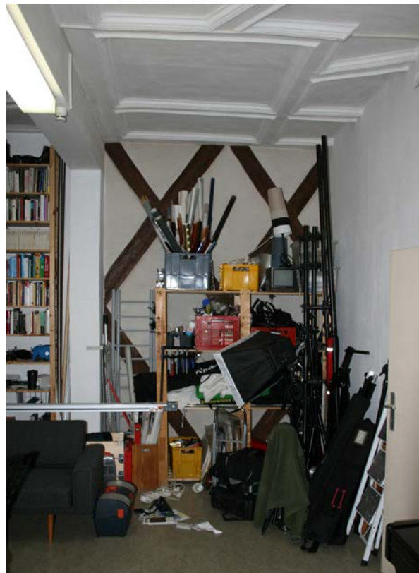
41 | EG, ehem. Sekretärsstube (HbN-EG05), Fachwerkwand gegen die Durchfahrt wohl aus Bauphase III.1b, Trennwand zur ehemals nördlich anschließenden Kammer (li.), 1954 abgebrochen und Trennwand gegen den Flur im Süden (re.) eingezogen (Nov. 2012)
