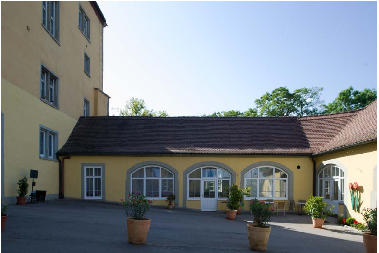
1 | Remise, Hofansicht gegen Westen, beim Umbau 1956 im Innern überformt und Einfahrtstore zu Fenstern geschlossen (Juli 2017) | © Isabel Muehlhaus TUM
