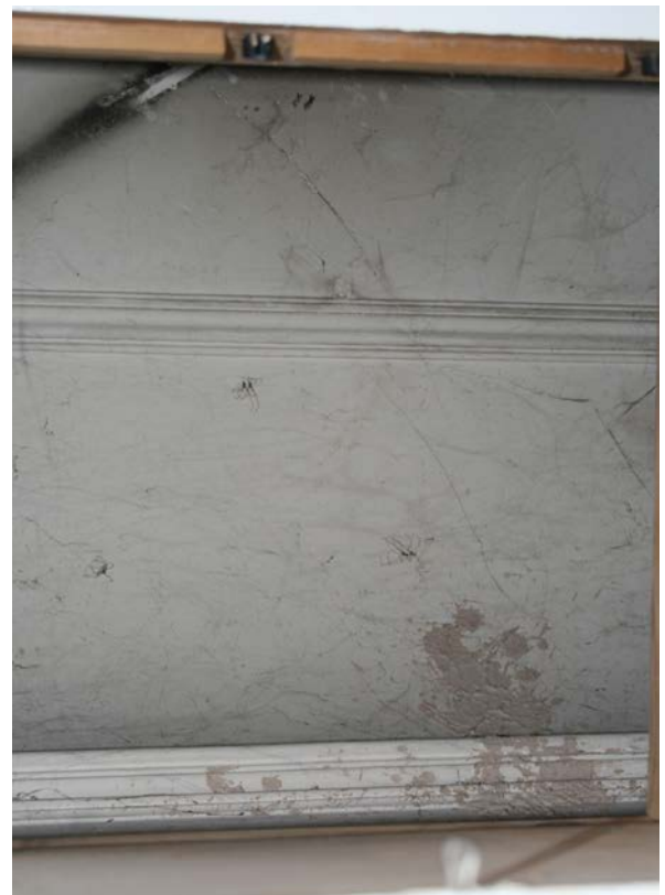
67 | Mansarde, Flur im Bereich der ehem. Kammer (HbW-1DG02), historische Deckenvoute mit säumenden Stuckprofilen unter der modernen Abhängung, 18./19. Jh. (Nov. 2012)
