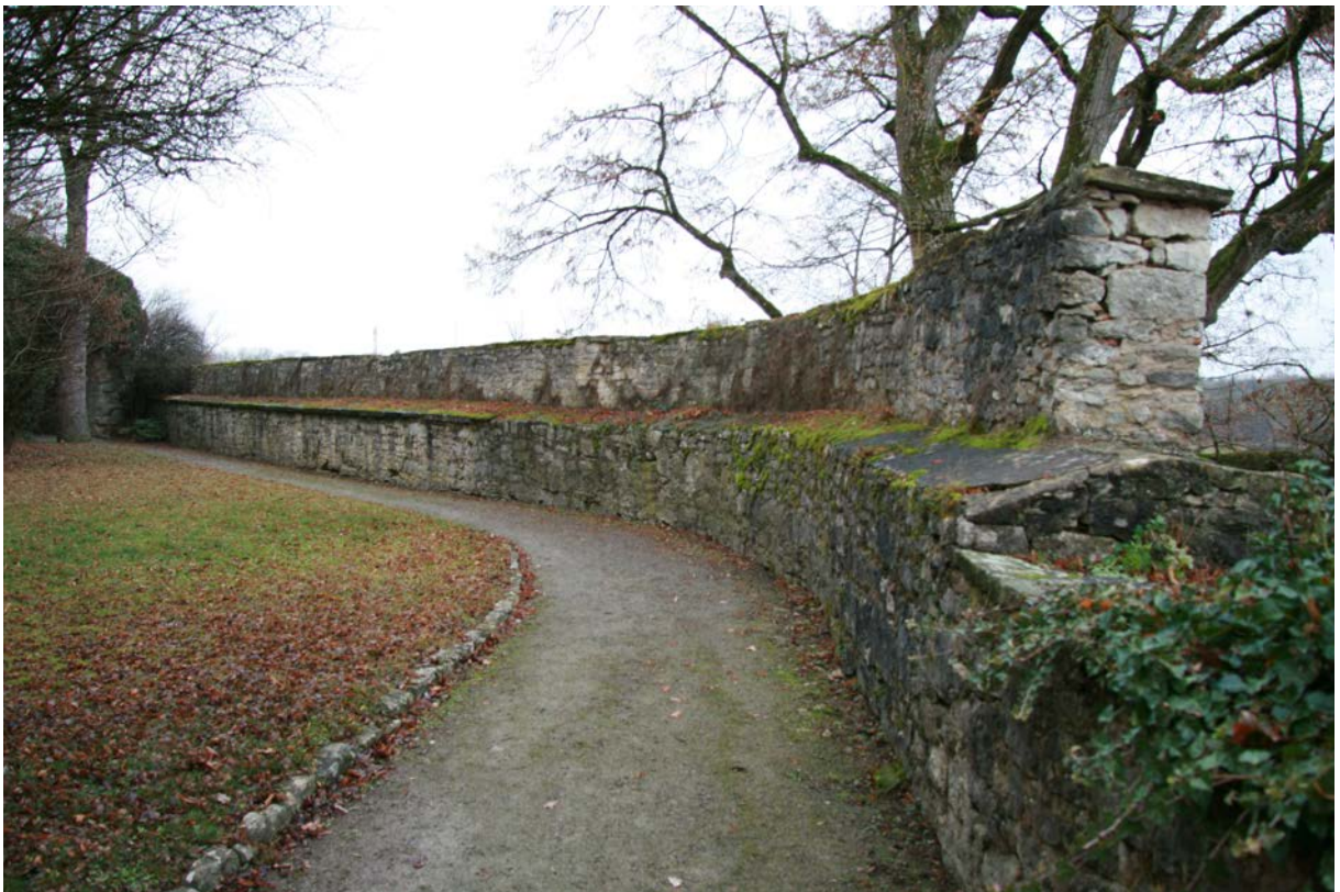
6 | Östlicher Schlossgraben, nördlicher Abschnitt der Schlossgrabenmauer mit dem Rest der teilgeschleiften Brustmauer, die die Außenseite der Grabenmauer einst umlaufend bekrönte (s. auch XVI.5) (Dez. 2016)
