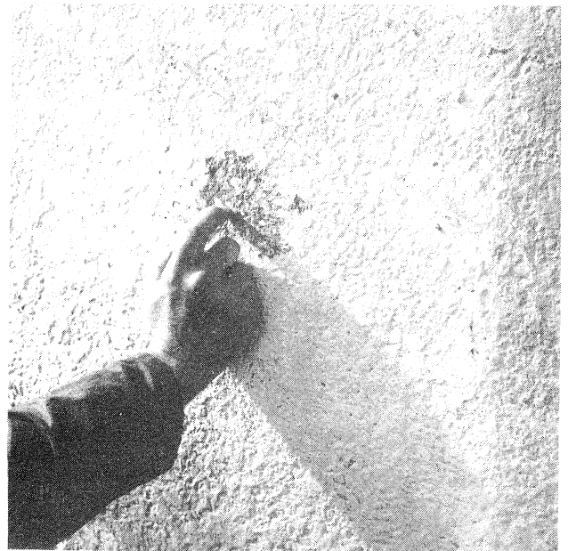
Bild 2: Wasserglas-Talkumanstrich. Trotz jährlichen Nachstreichens ist der Untergrund, hier Sichtbeton, schon stark angegriffen
