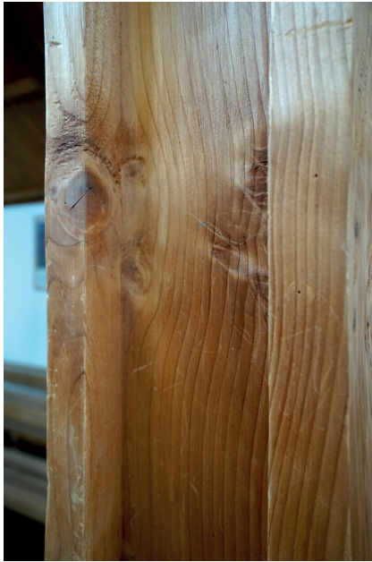
Abb. 103: Detail einer Stütze in der Friedenskirche in Neufahrn, woraus klar wird, dass die Stütze aus einem Holzquerschnitt gebrannt wurde
