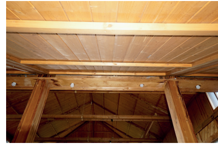
Abb. 95: Originale Leuchtauslässe und feuchtebedingte Schädigungen bei der Christuskirche in Viechtach
