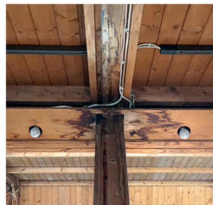
Abb. 76: Feuchtebedingte Verfärbungen unterhalb des Glockenträgers
