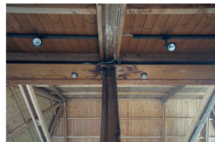
Abb. 101: Die originale Beleuchtung in der Christuskirche in Viechtach wurde zwischenzeitlich durch Lichtschienen ergänzt, was zumindest denkmalfachlich fragwürdig ist.
