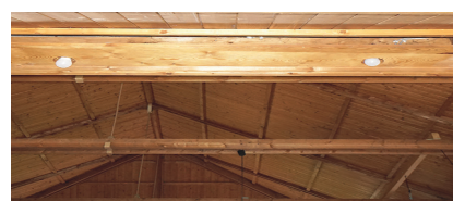
Abb. 63: Ursprüngliche Beleuchtung unterhalb des Frieses, Neufahrn
