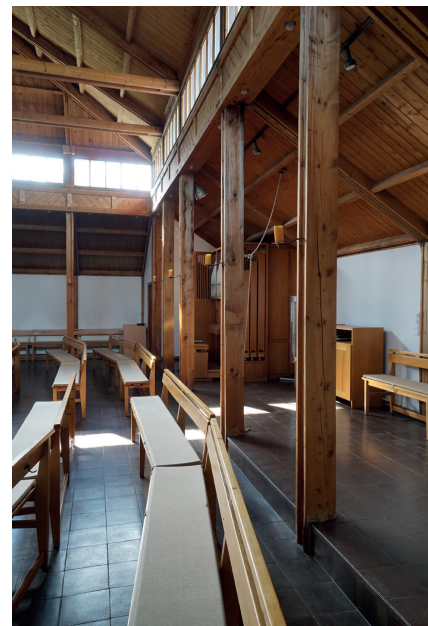
Abb. 96: Feuchteschäden in der Christuskirche in Viechtach im Bereich des Sängerpodiums
