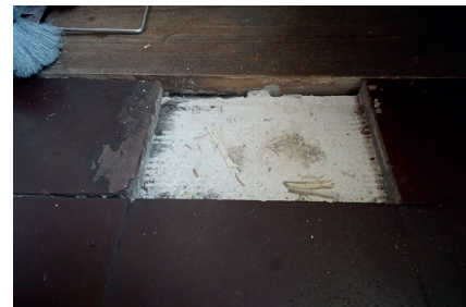
Abb. 100: Originaler Plattenbelag in der Kreuzkirche in Pocking. Eine gelockerte Platte konnte entnommen werden. Sie besteht wohl aus Holzzement
