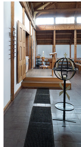
Abb. 74: Auslässe der Umluftheizung
