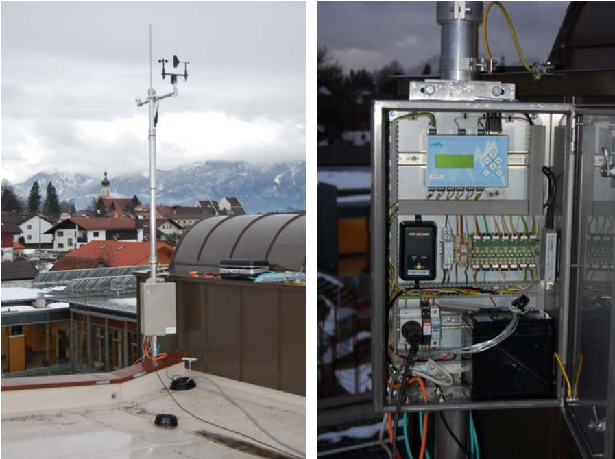
Abbildung 37: Wetterstation auf dem Dach der Turnhalle mit Mast, Blitzableiter, Sensoren an Ausleger und Schaltschrank (links), geöffneter Schaltschrank mit Datenlogger (rechts)
