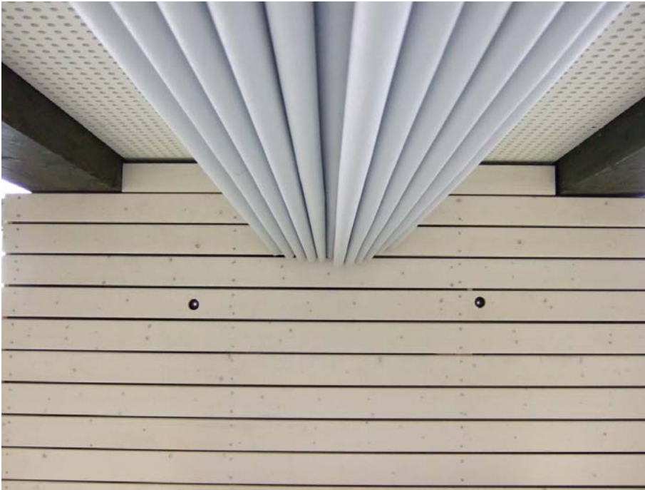
Abbildung 22: LEDs zweier Referenzpunkte hinter Verschalung im Bereich der nördlichen Auflager
