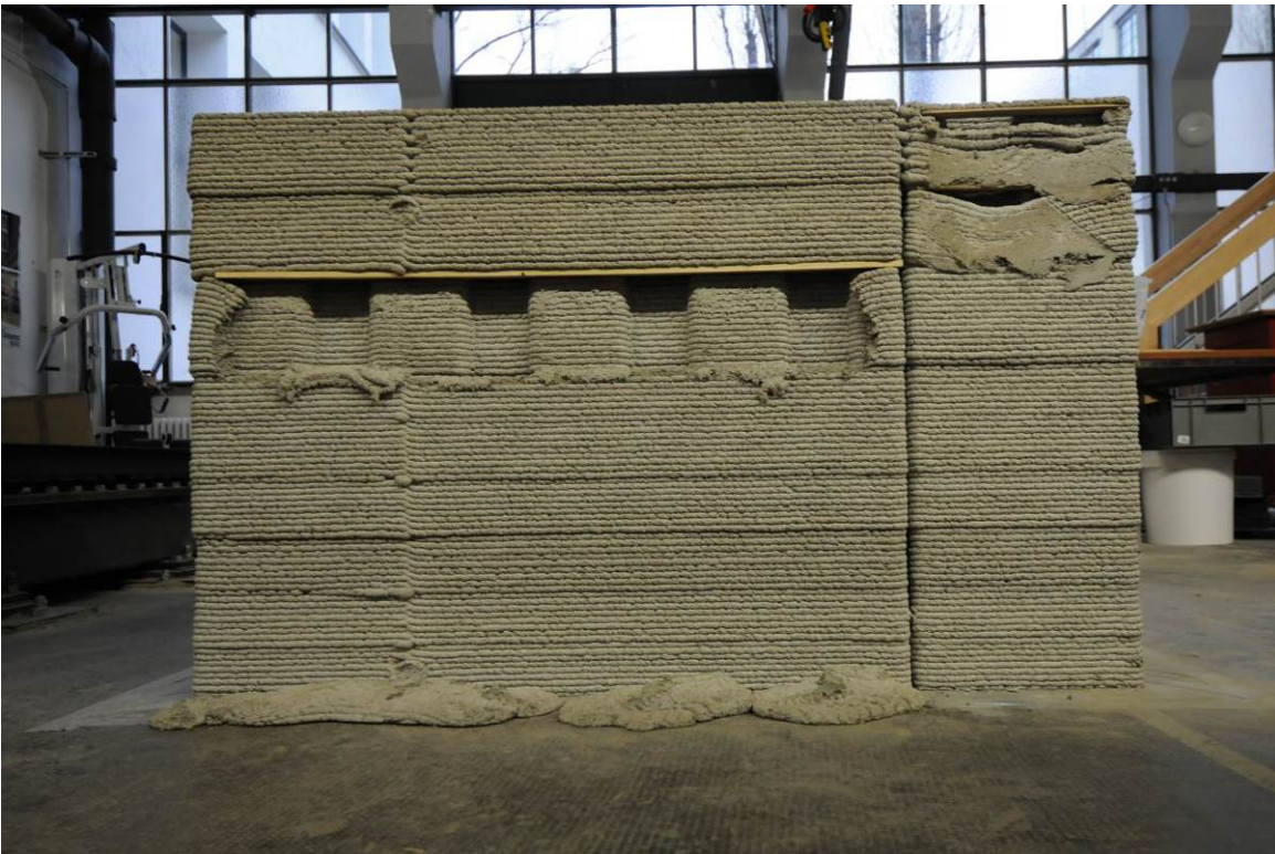
Abbildung 80: Rückseite der Testwand mit Ausbrüchen
