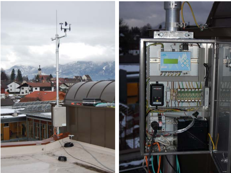
Abbildung 37: Wetterstation auf dem Dach der Turnhalle mit Mast, Blitzableiter, Sensoren an Ausleger und Schaltschrank (links), geöffneter Schaltschrank mit Datenlogger (rechts)
