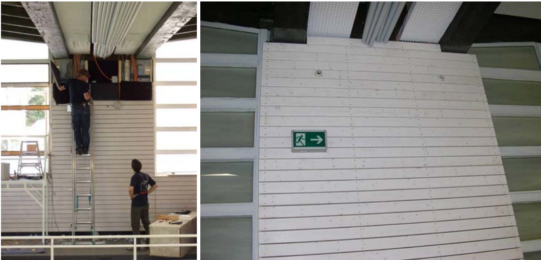
Abbildung 20: Kameras unterhalb der Auflager der Hauptträger, während (links) und nach Abschluss der Montagearbeiten (rechts)
