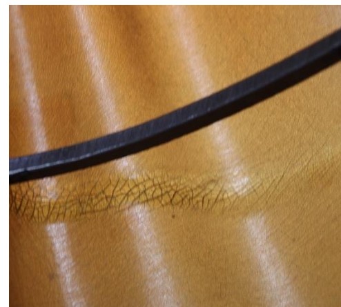
Abb. 33: Detail stärkere Versprödung an Metallstrebe bei Referenzobjekt (Ausschnitt etwa 10 cm groß) (Foto: JS, 07.2017)
