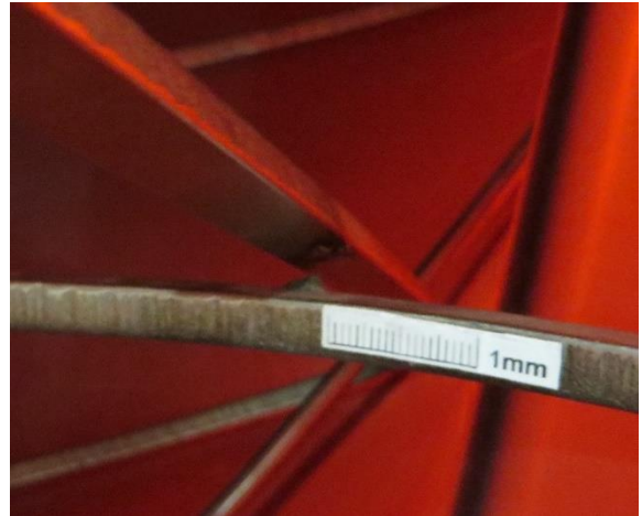
Abb. 27: Detail gebrochener Schweißpunkt (Foto: JS, 11.2017)
