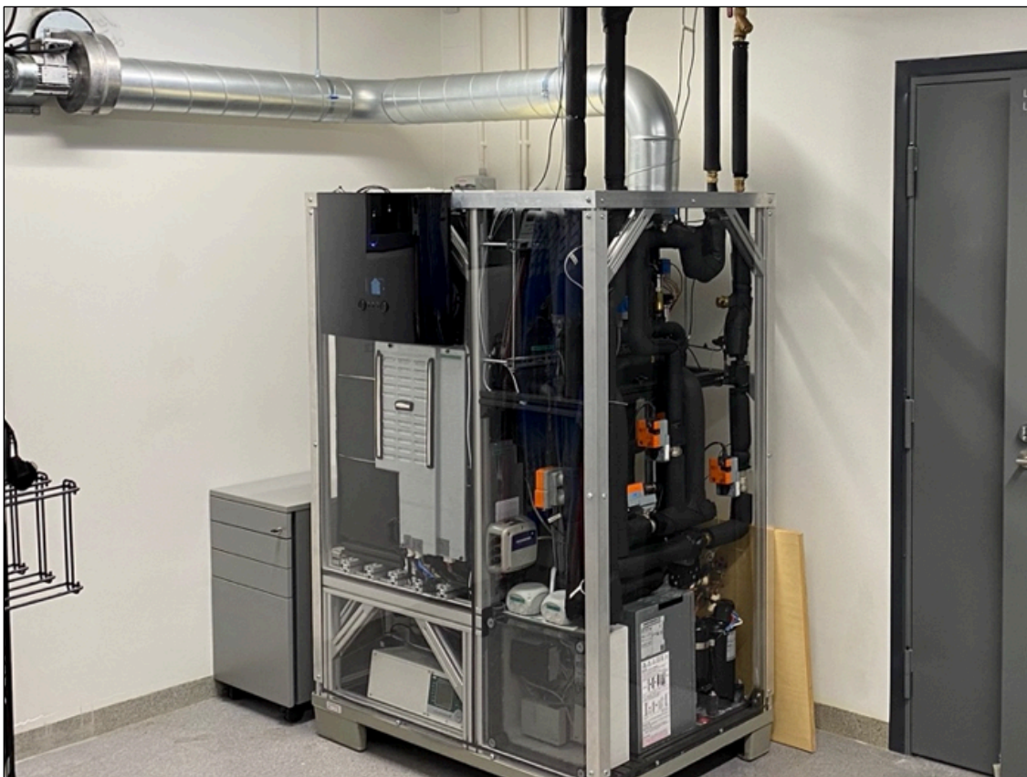
Abb.97: Versuchsanlage nach Pilotinstallation zur Durchführung des Dauertests
