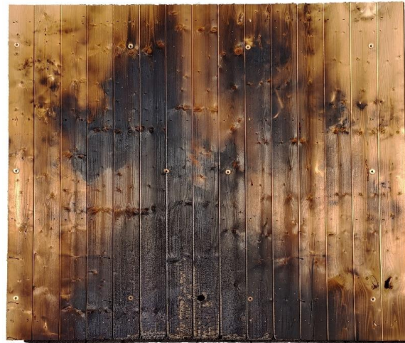
Abbildung 6: Fotodokumentation der Holzschalung oberhalb der Brandsperre nach Beendigung des Versuchs und der Beobachtungszeit für Test 3
