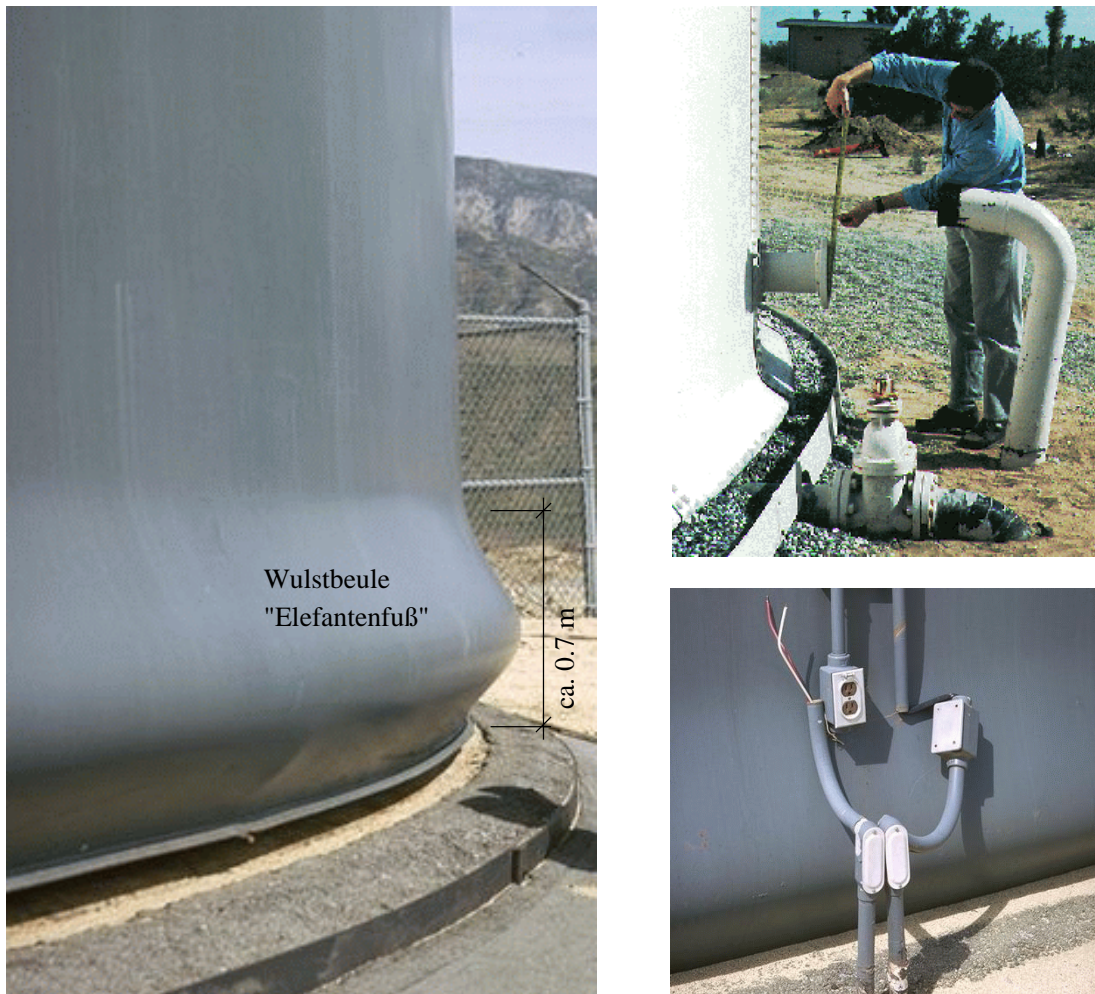
Abb. 6.2: Schadensfälle unverankerter Flüssigkeitsbehälter nach einem Erdbeben
