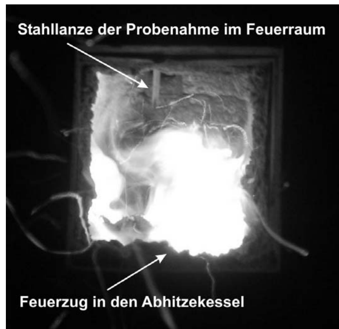
Abbildung 73: Aufnahme des Feuers im Feuerraum durch den Wärmetauscher hindurch. Erläuterungen siehe Text
