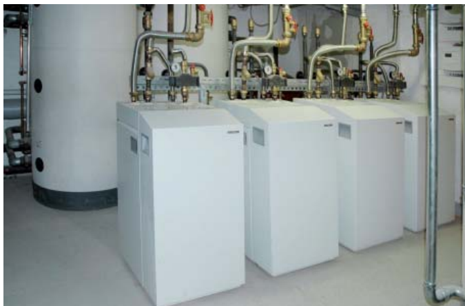
Abb. 5.11: Vier Module einer Wärmepumpe, im Hintergrund Pufferspeicher für Kellerraum, Dachau, Birkenrieder Straße 2–4
