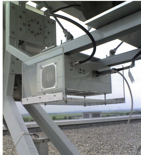
Abb. 3-15: Leistungsendverstärker in der Endmontage am Drehstand
