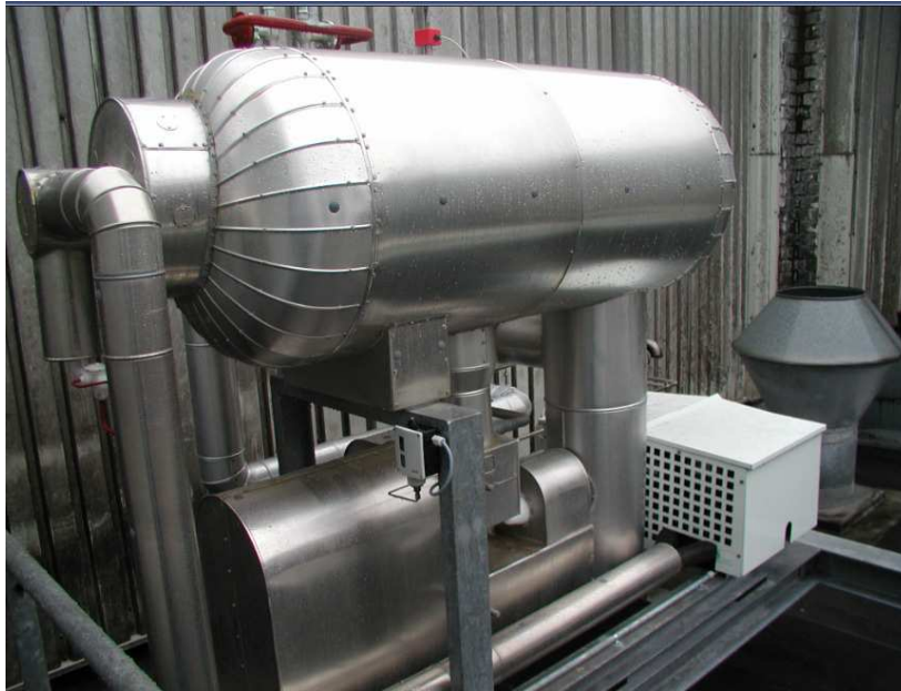
Abbildung 52: Wärmeübertrager zur Verflüssigung von Gärungs-CO 2 an der Versuchsanlage
