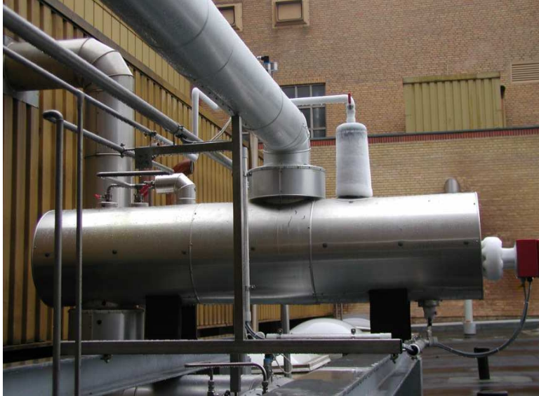
Abbildung 55: Separationstank der Versuchsanlage auf dem Dach der Brauerei
