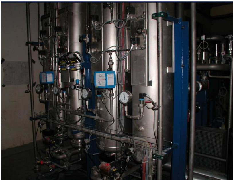
Abbildung 54: Trockner- und Reinigerkolonnen der Versuchsanlage
