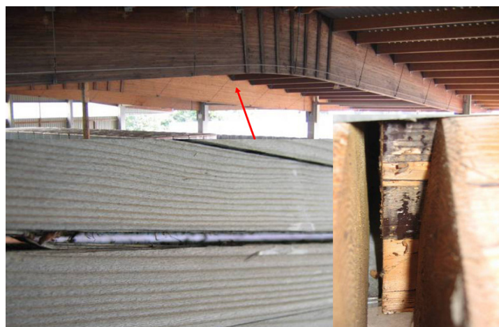
Abb. 4.4: Schub- und Zugbrüche in einer Zugverbindung aufgrund Blockscherversagens
