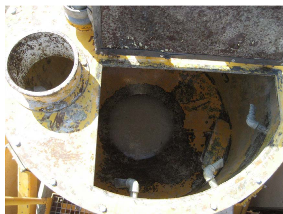
Abbildung C.8: Blick in die Mischanlage
