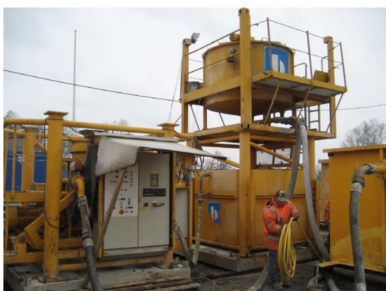
Abbildung C.7: Mischanlage mit Hochbehälter
