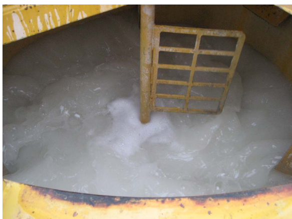
Abbildung C.23: Rührwerk im Hochbehälter
