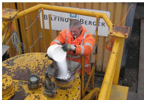
Abbildung C.14: Zugabe des Polymers zur Mischanlage
