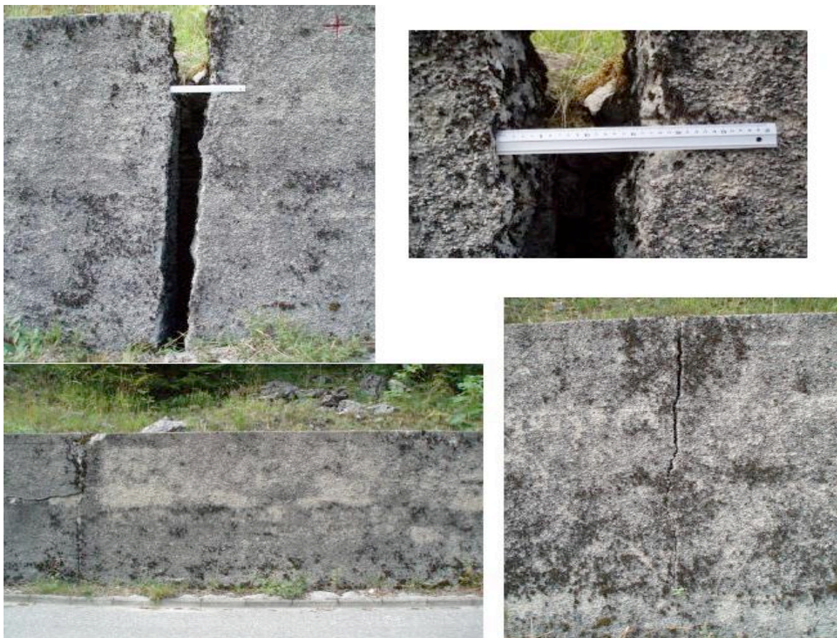
Abb. 7: Schäden an den Stützmauern entlang der Straße Rosengasse – Grafenherberg im Bereich der Aggenalm (JUNG 2007: Abb. 29 und Abb. 30).
