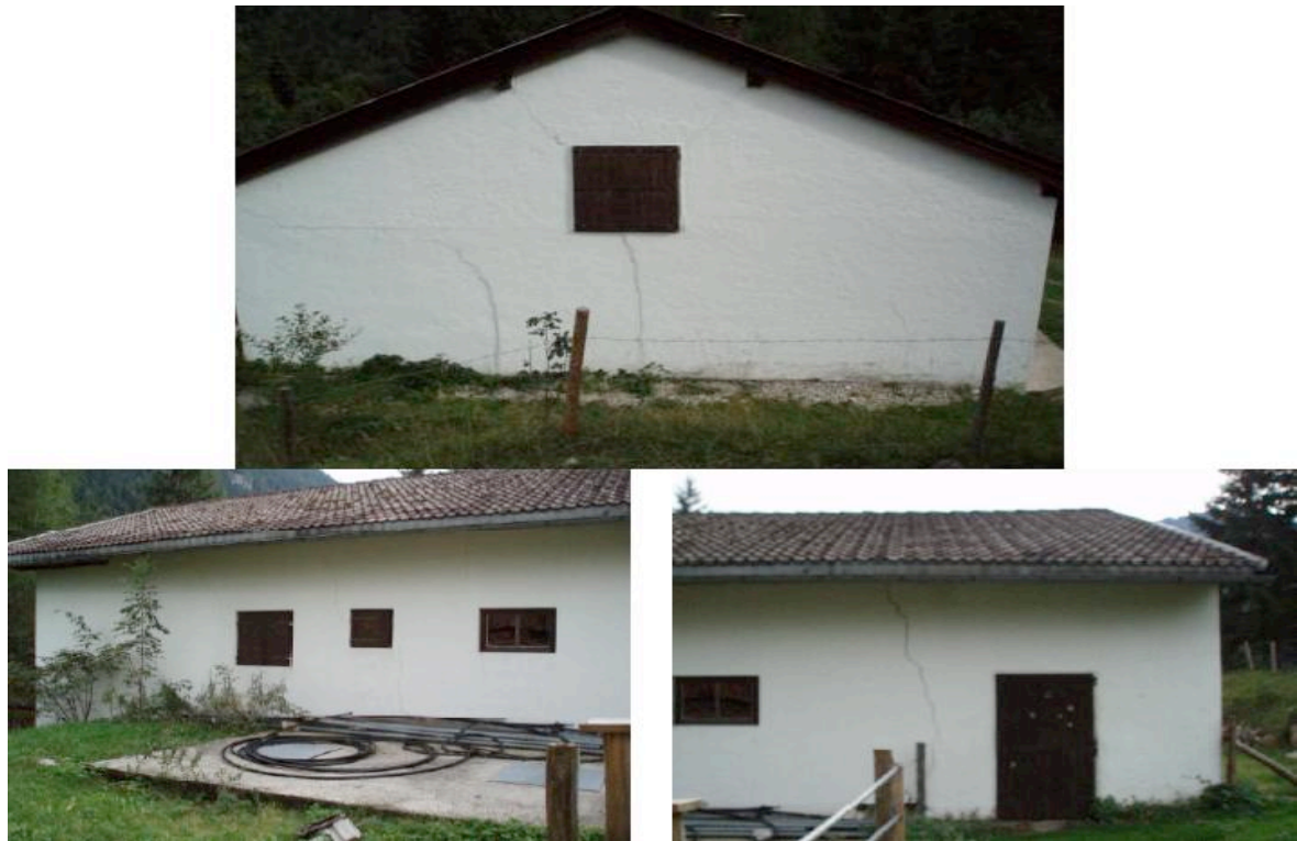
Abb. 6: Frische Risse in den Wänden von Almhäusern auf dem Rutschkörper (JUNG 2007: Abb. 21, Abb. 23).
